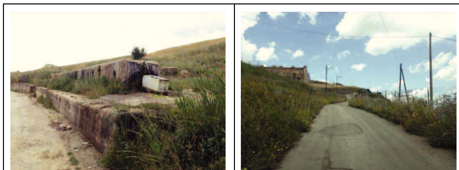
Figura 26 Edifici e manufatti in stato di degrado, posti lungo la viabilità secondaria e nelle vicinanze del sito di conferimento.
