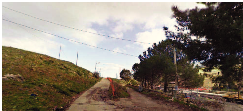
Figura 14. Alcuni tratti in prossimità dello scalo ferroviario della viabilità secondaria per Casa Tani Japico. Si noti lo stato dissestato della carreggiata nel tratto di salita.
