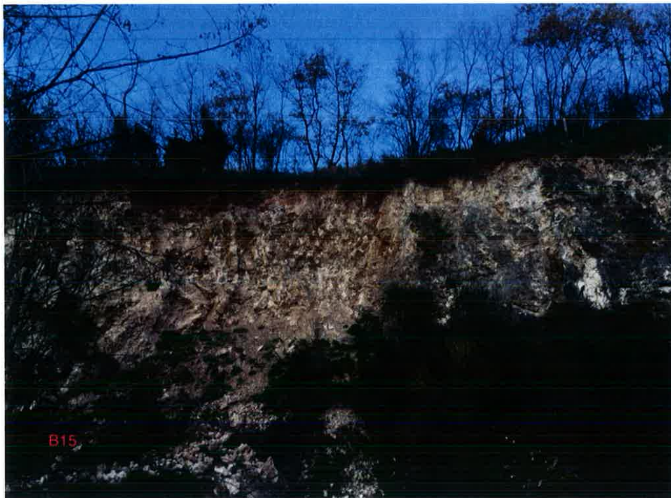
Foto 9 – Fenomeni di crollo s.l. che interessano i termini calcareo-marnosi delle Argille Varicolori Superiori.
