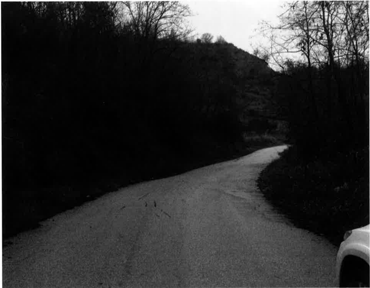
Foto 11 – deformazioni e cedimenti sulla sede della strada provinciale a monte dell’imbocco orientale della galleria Cantone
