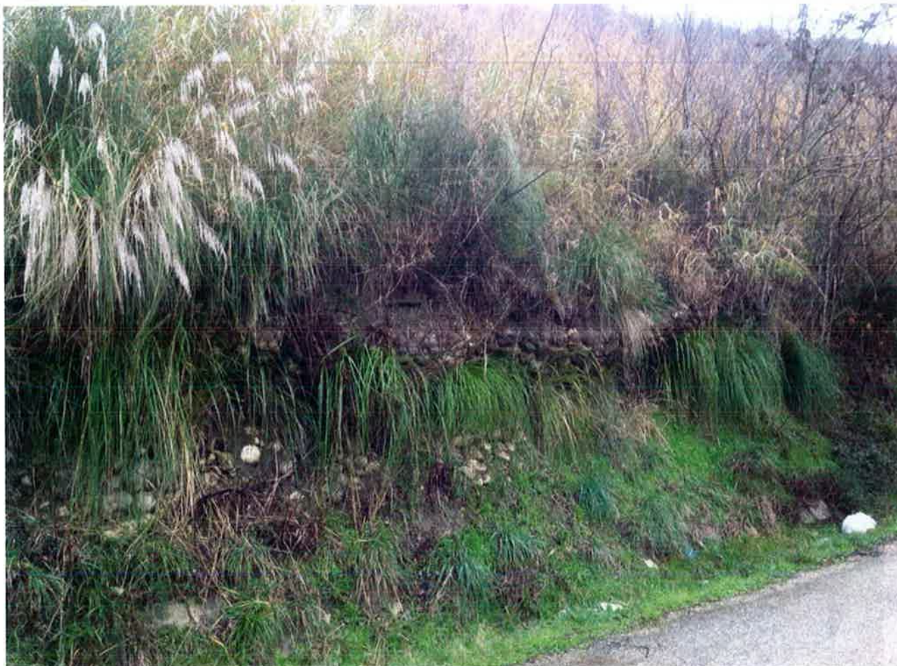
Foto 12 – Deformazioni e cedimenti sulla sede della strada provinciale a monte dell’imbocco orientale della galleria Cantone, sono evidenti le parziali deformazioni dei gabbioni nella zona sommitale, dove si concentrano prevalentemente le spinte delle coltri localmente rimobilizzate.
