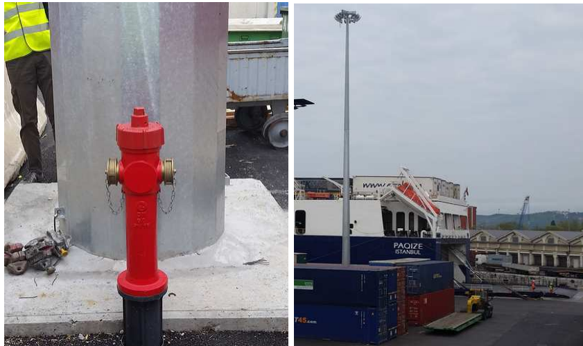
Figura 6: idrante presente ai piedi della torre faro posta subito a sud dell'attracco attuale (nella foto a destra)
