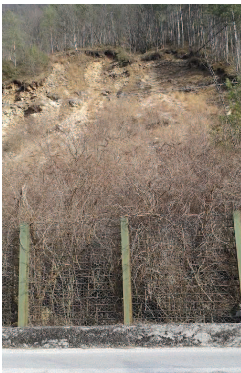
Figura 7.4 - Smottamento a margine della SP84
