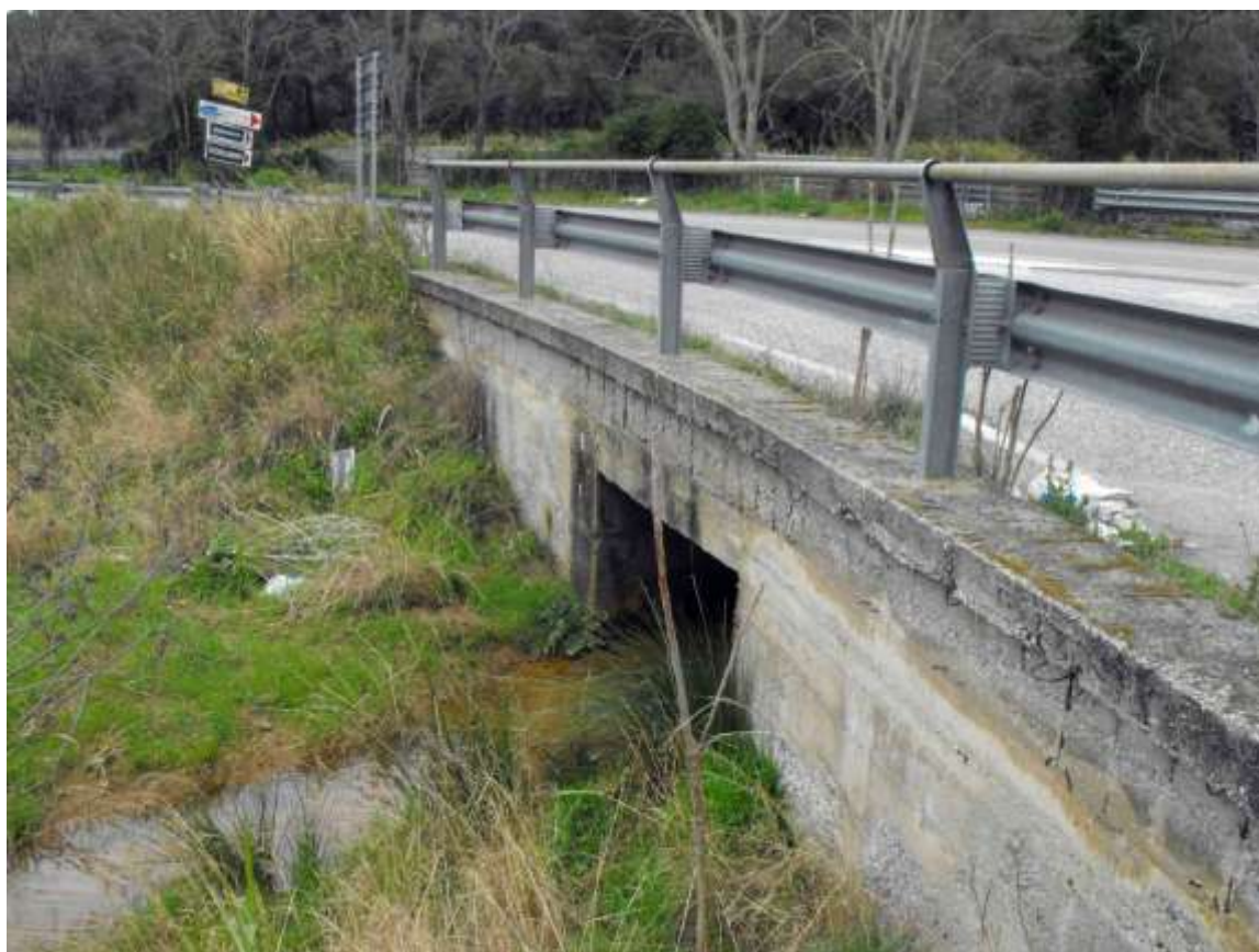
Foto 6. Particolare del tombamento sotto la SP 169 che allaga il sito della CTE
