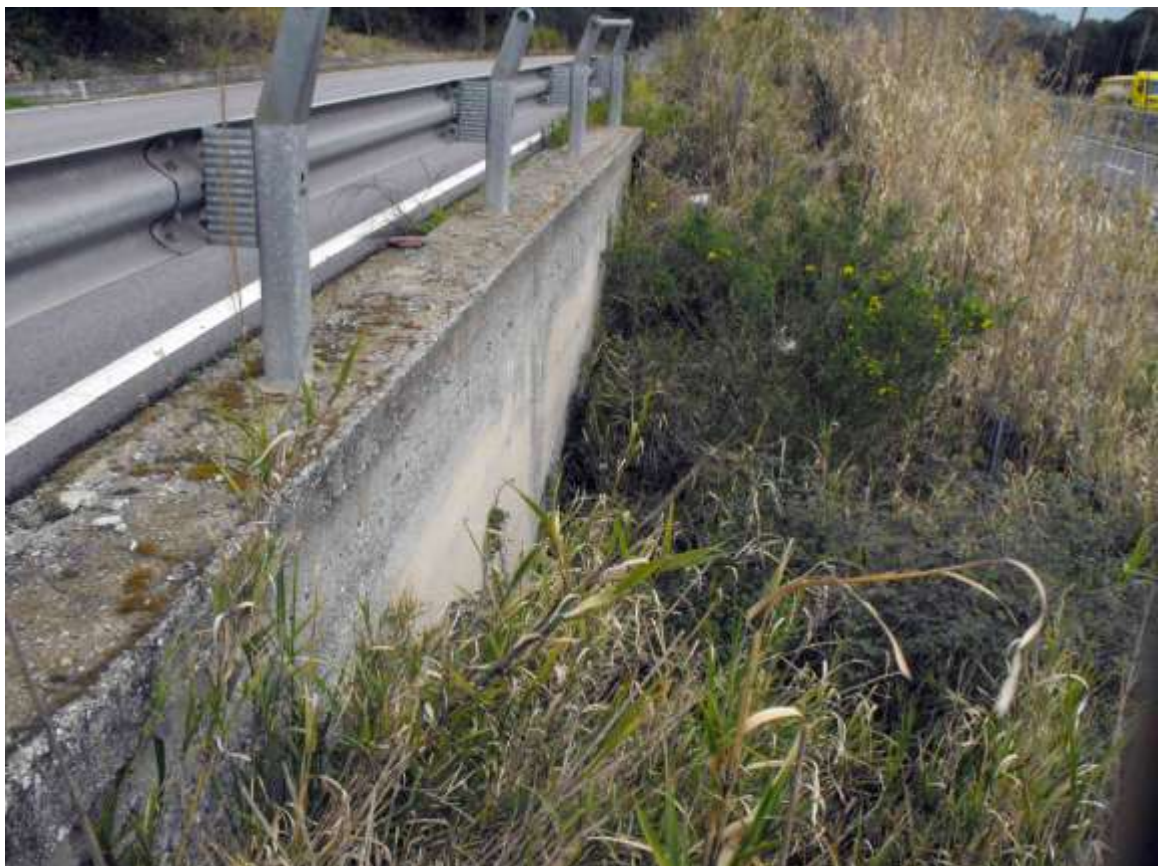
Foto 16. Interferenza n. 8 – particolare del tombamento (prospetto sud)
