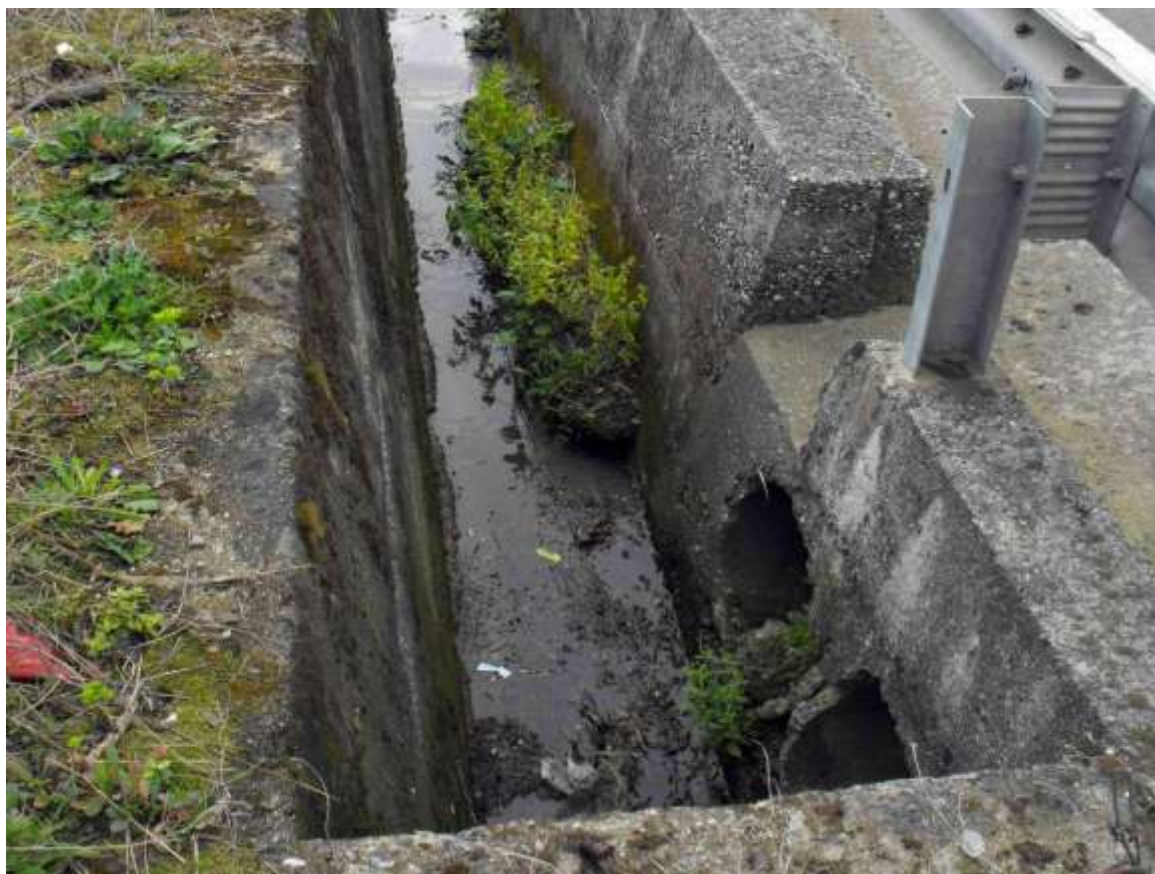
Foto 36. Interferenza N.15: doppia tubazione in c.l.s. interrata Ø 600 (lato sud)
