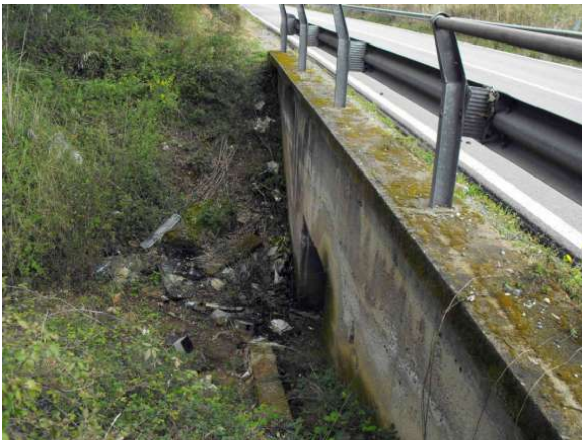
Foto 11. Interferenza n. 7 – particolare del tombamento (lato nord)
