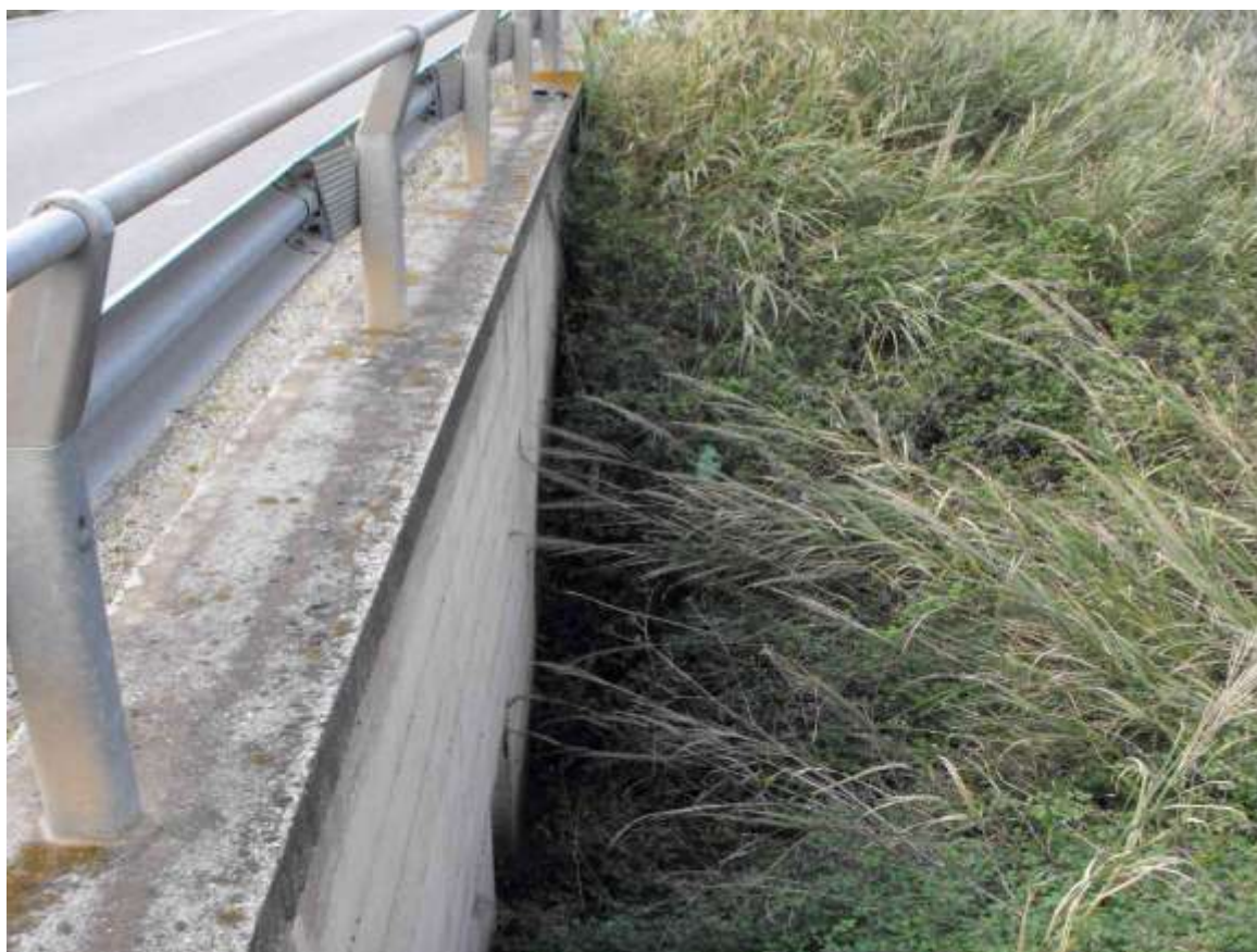
Foto 44. Interferenza N.17: tombino scatolare (lato nord)
