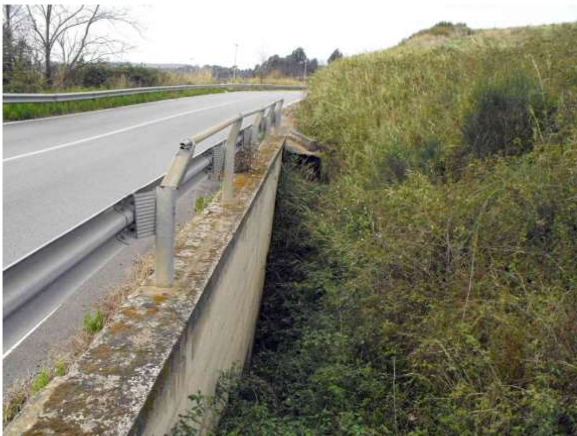
Foto 52. Interferenza N.22: tombino scatolare (lato nord)
