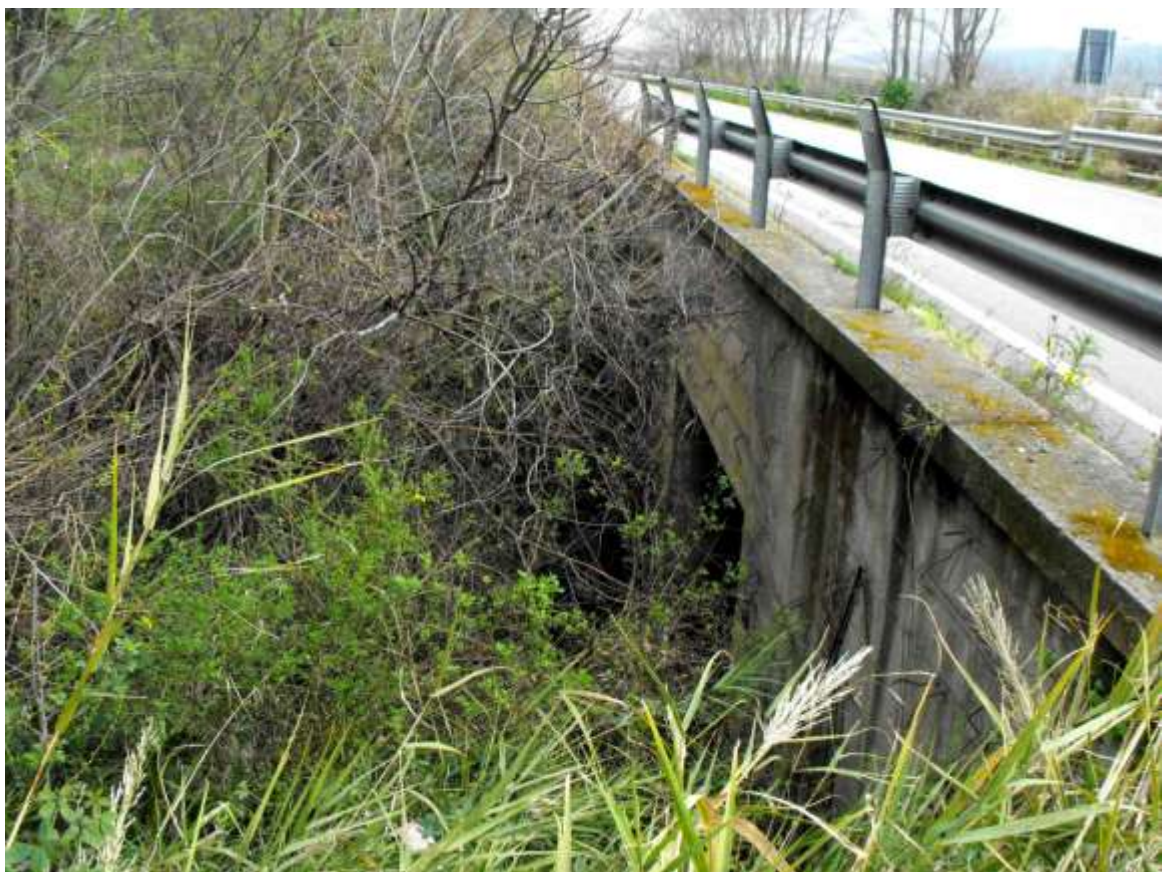
Foto 38. Interferenza N.16: tombino scatolare (lato nord)
