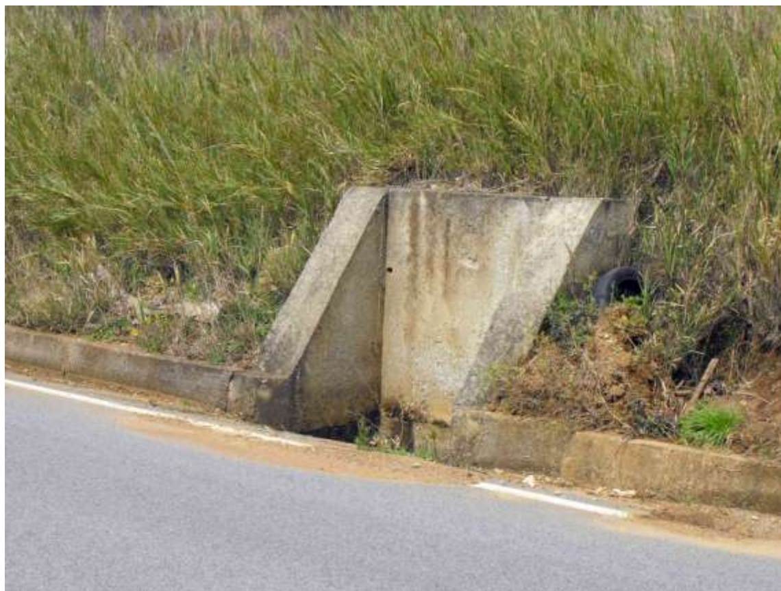
Foto 48. Interferenza con tombamento di scolo (tubo c.l.s. intasato) – N.18
