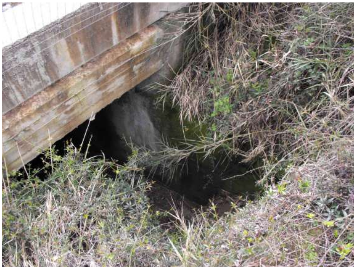
Foto 12. Interferenza n. 7 – particolare del tombamento (lato sud)
