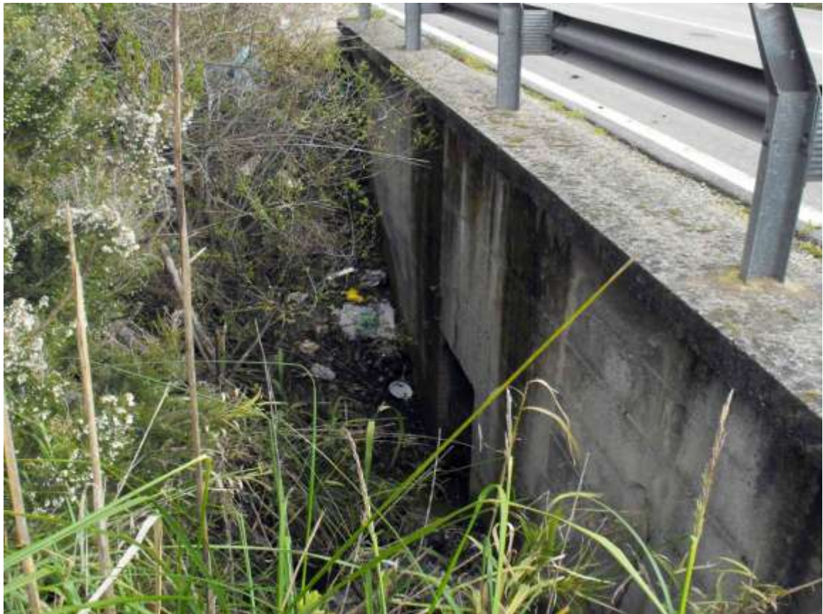
Foto 15. Interferenza n. 8 – particolare del tombamento (prospetto nord)
