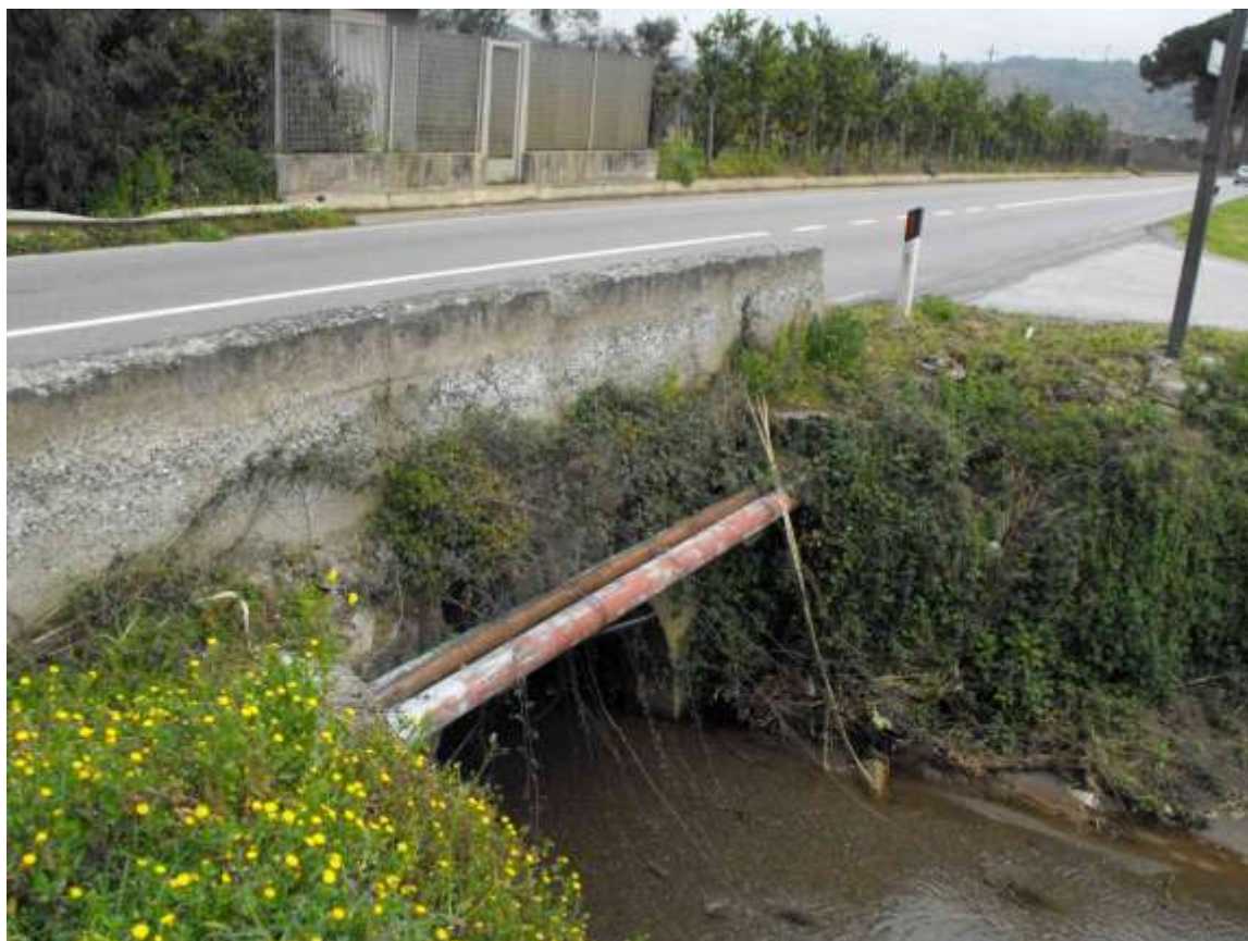
Foto 107. Particolare dei sottoservizi ancorati alla struttura del ponticello
