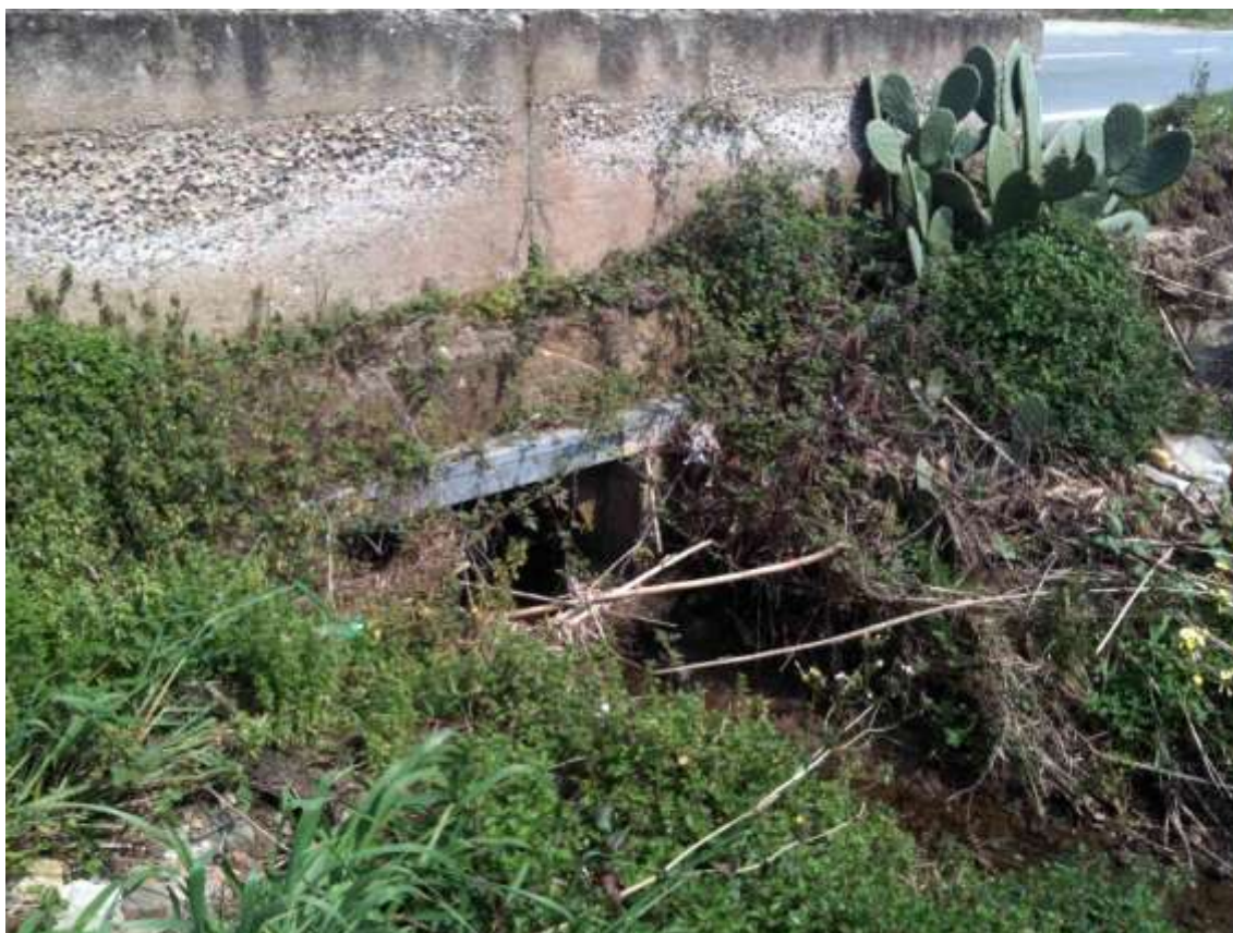
Foto 115. Interferenza N. 40: prospetto sud del tombino
