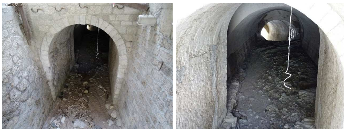
FOTO 5-6– La tombinatura del Ru Sec sotto il paese con i resti del trasporto solido
