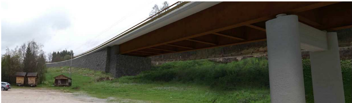
Fig. 12 La zona sottostante il viadotto in corrispondenza del parcheggio della zona artigianale.
