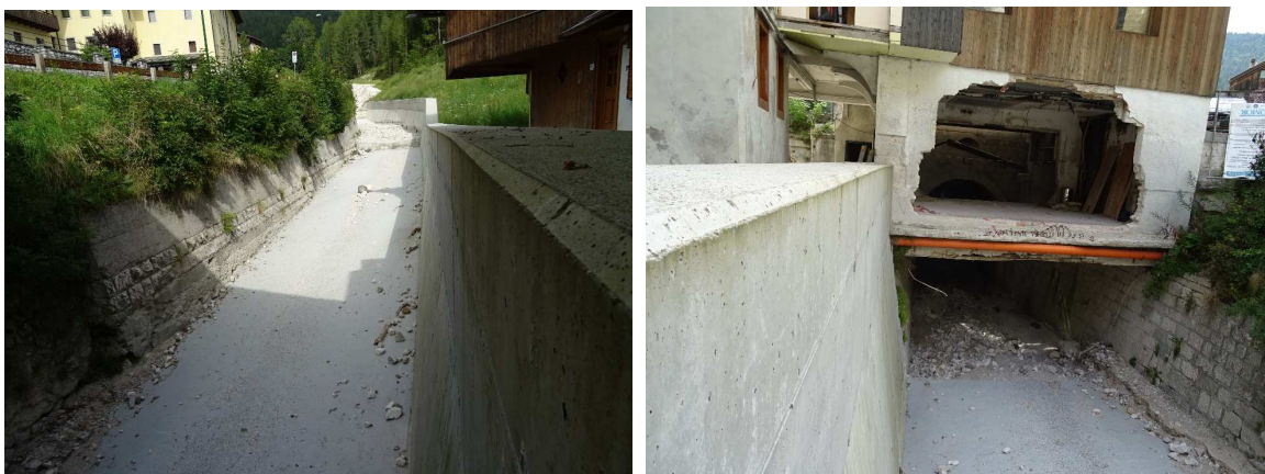
FOTO 3-4– Il Ru Sec nel tratto rivestito a monte del paese e la tombinatura lesionata a seguito degli eventi del 2015
