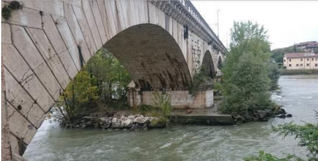
Figura 8: Blocchi di consolidamento delle pile del ponte ferroviario esistente della linea storica Milano – Venezia.
