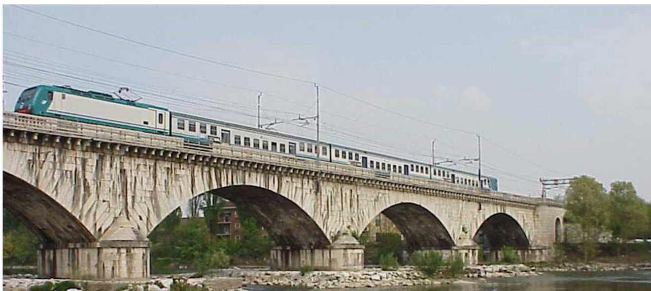
Figura 3-3 Viadotto sul fiume Adige – Linea storica Campate centrali di luce 29 m - Punto di presa a sud del viadotto
