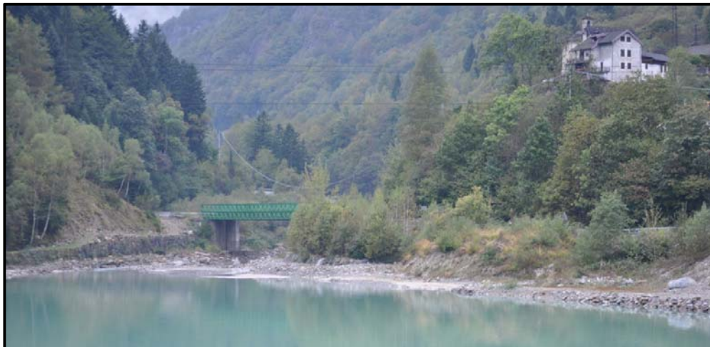
Figura 4.2.9b Ponte della Strada di Macugnaga sul torrente Anza a causa del cantiere per la realizzazione della galleria
