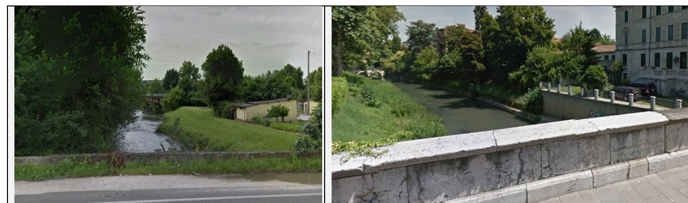
Figura 4-5 Vista dalla SR11 in direzione del ponte ferroviario, interessato dall'intervento, che attraversa il Fiume Retrone (fonte: Google Maps)
