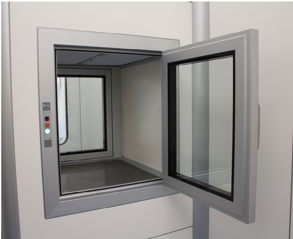
Fig. 3 – Pass Box per ingresso MCA.
