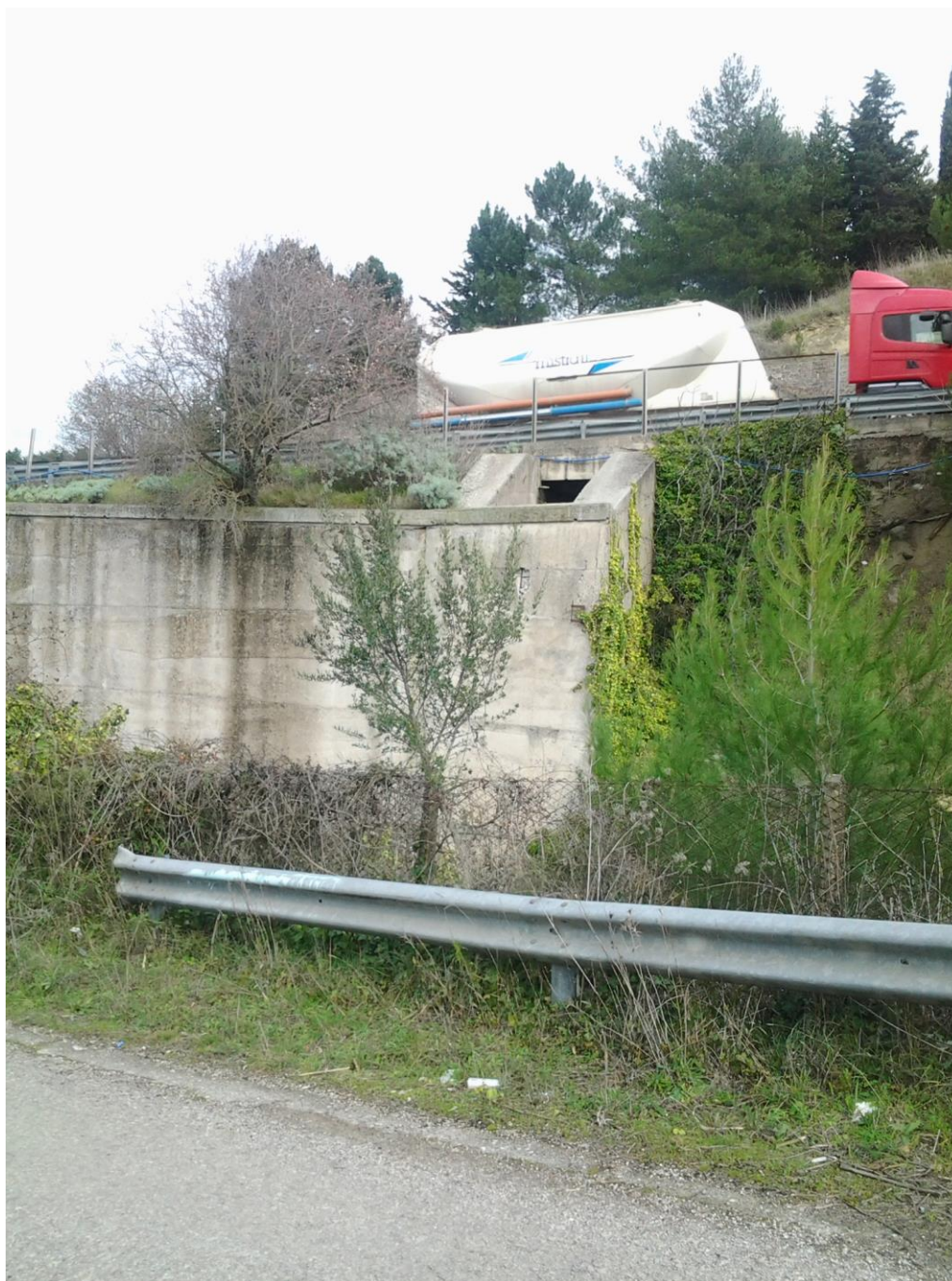
Foto 5 opera di attraversamento della attuale sede della SS 131 Carlo Felice (Vista da valle)
