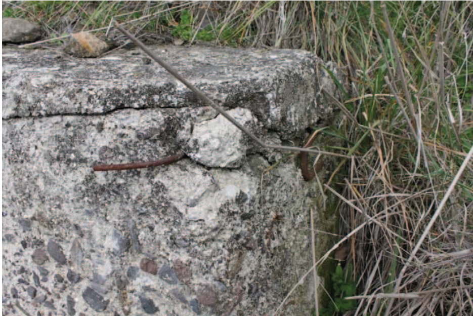
Figura 4. Opera di controripa esistente sulla SP 125 – evidenze di calcestruzzo ammalorato e di scarsa qualità, di copriferro insufficiente, ed armature arrugginite e non regolari.
