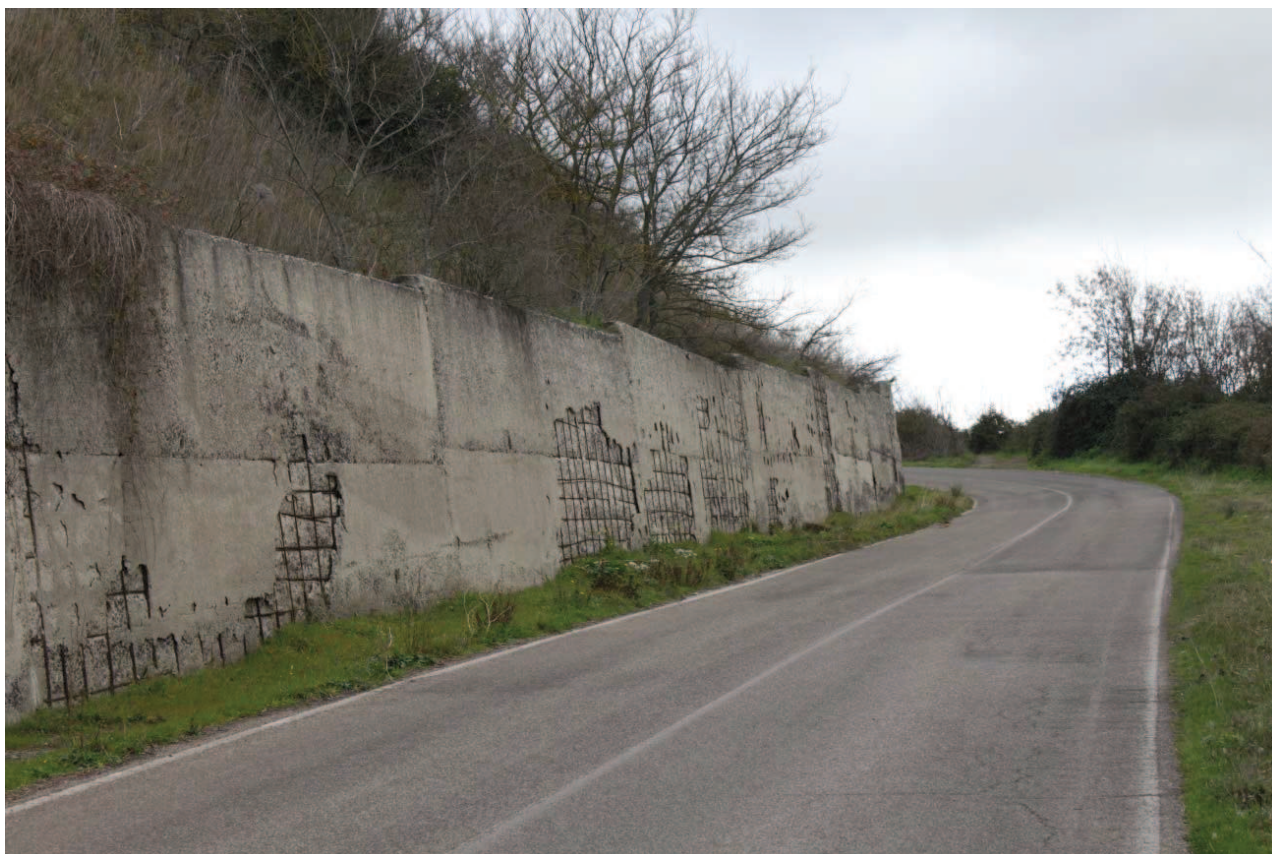
Figura 1. Opera di controripa esistente sulla SP 125 – evidenze di calcestruzzo ammalorato e di scarsa qualità, di copriferro insufficiente, ed armature arrugginite e non regolari.
