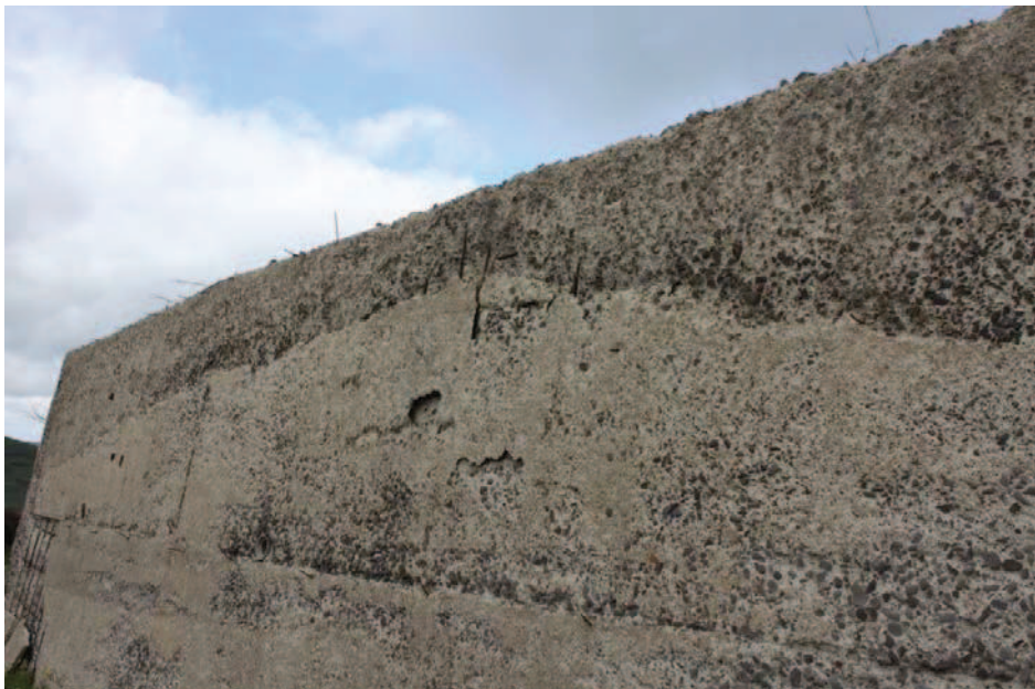
Figura 3. Opera di controripa esistente sulla SP 125 – evidenze di calcestruzzo ammalorato e di scarsa qualità, di copriferro insufficiente, ed armature arrugginite.
