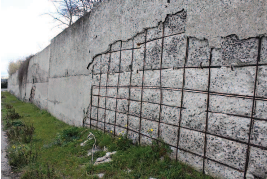
Figura 2. Opera di controripa esistente sulla SP 125 – evidenze di calcestruzzo ammalorato e di scarsa qualità, di copriferro insufficiente, ed armature arrugginite e non regolari.
