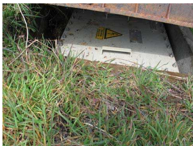
Foto 3: Pozzetto Giunto Elettrico, Linea MTI Parco Eolico
