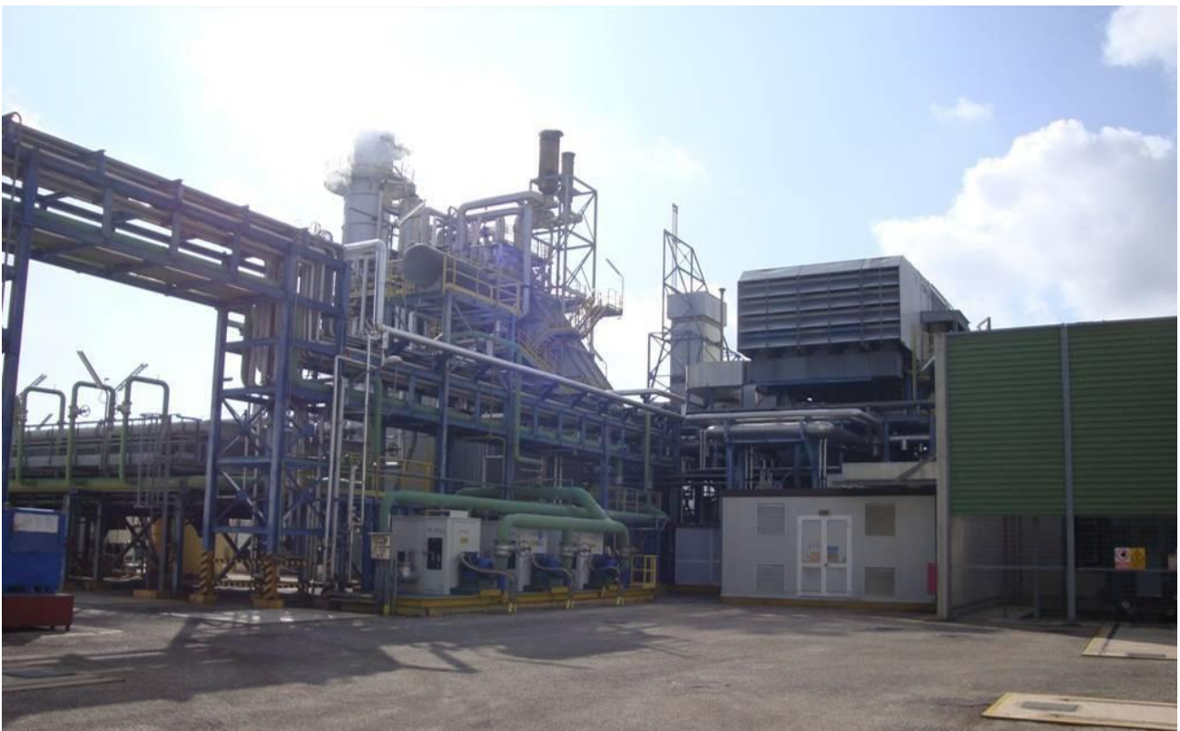
Vista di alcuni impianti- Coibentazioni
