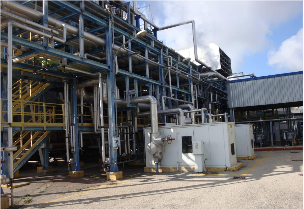
Tubazioni afferenti- Coibentazioni
