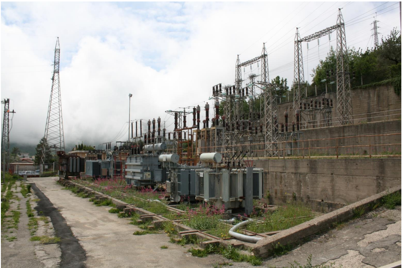
Figura 9: Cabina Primaria di Vico titolarità di ENEL Distribuzione.
