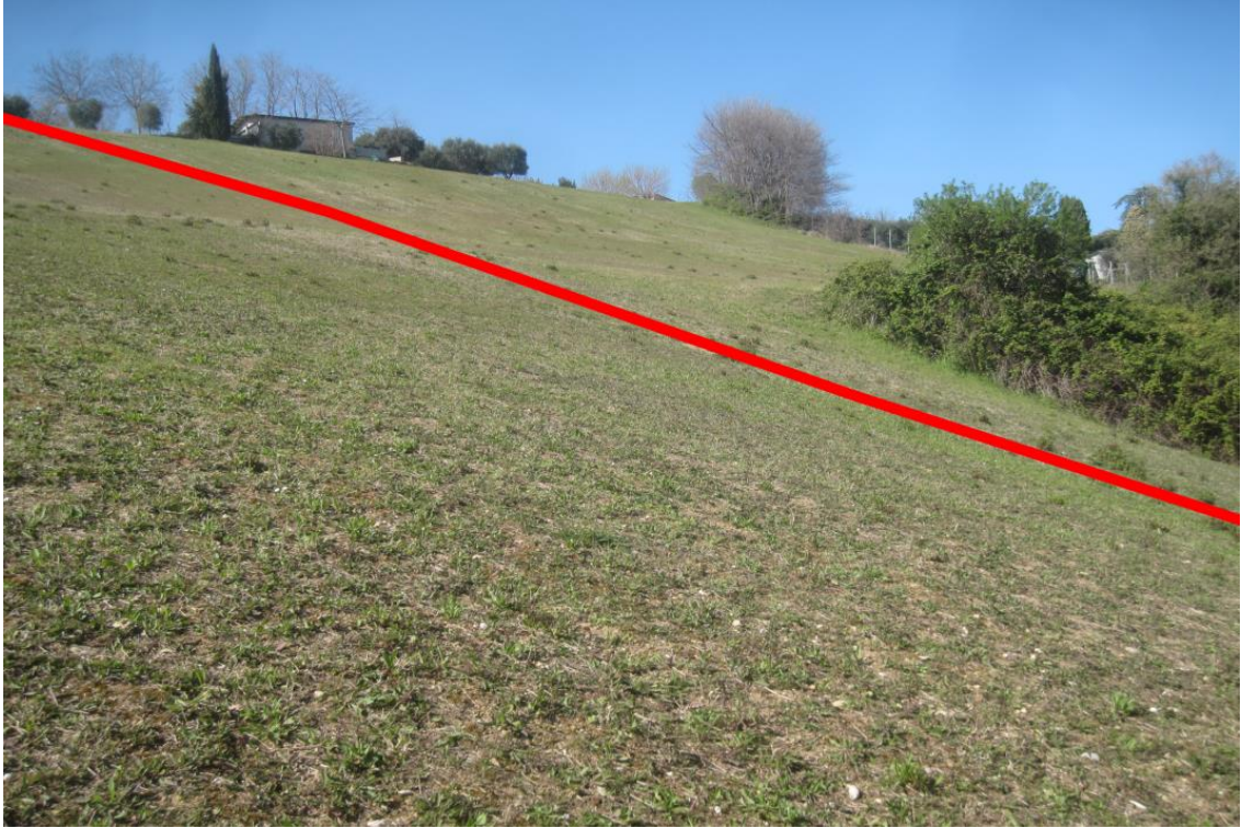
Foto 7 – Area 7. Attraversamento in posizione marginale del dissesto
