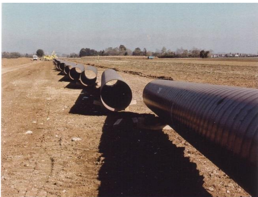
Foto 3.2/D: Esempio di sfilamento tubazioni.
