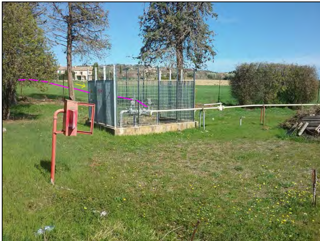
Foto 62: Coll. Civitanova Marche 2° presa DN 150 (6\"), DP 75 bar. Tratto finale con arrivo nell'area dell'impianto esistente (Borgo Stazione di Montecosaro).
