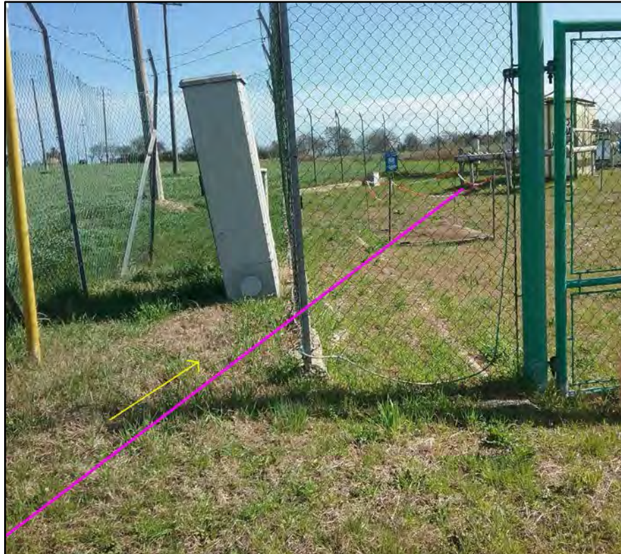
Foto 61: Rif. Gas Plus di Montecosaro DN 100 (4\"), DP 75 bar. Tratto finale con arrivo nell'area dell'impianto esistente (Borgo Stazione di Montecosaro).
