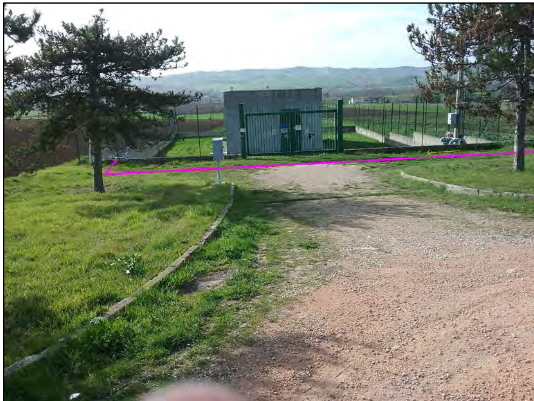
Foto 54: Rif. Comune di Recanati 2° presa DN 100 (4"), DP 75 bar. Tratto finale con entrata nell'impianto esistente.
