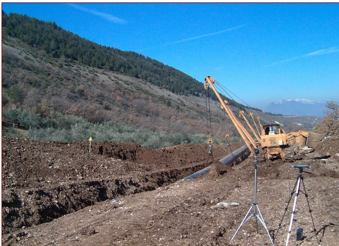
Figura 4/A – Rilievi acustici durante la posa della condotta in un cantiere analogo
