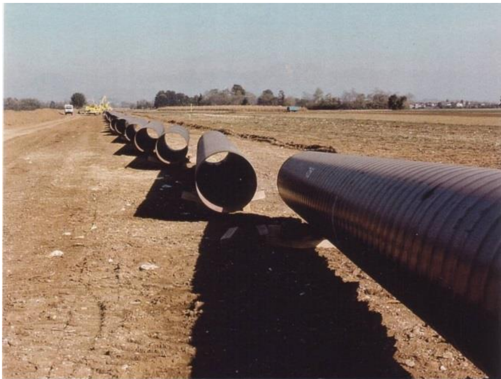
Foto 5.1/D: Esempio di sfilamento tubazioni.
