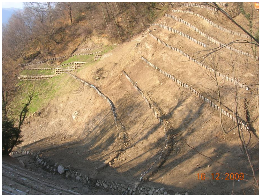
Foto 5.1/K: Esempio di ripristino morfologico e consolidamento di un versante con opere di ingegneria naturalistica (palizzate e palificate)
