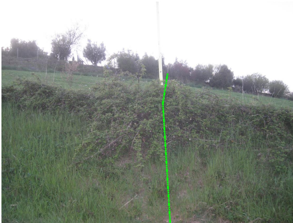
Foto 28 – Area 47. Vista del dissesto dalla strada di fondovalle
