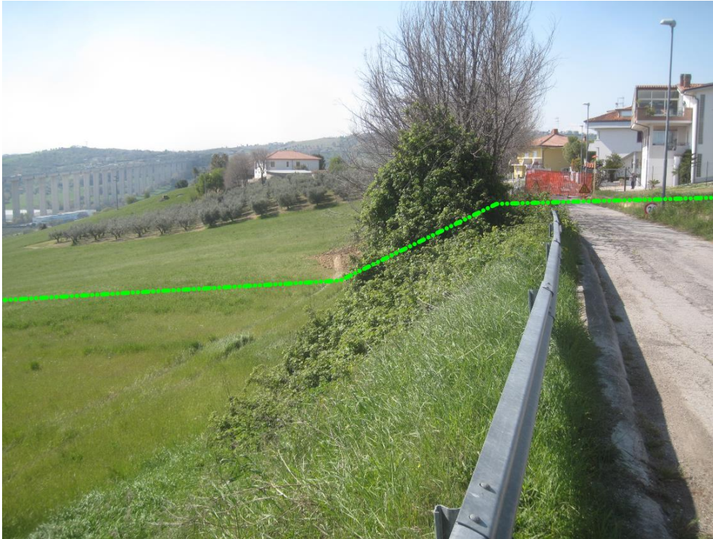
Foto 30 – Area 49. Vista della testata del dissesto a valle della strada
