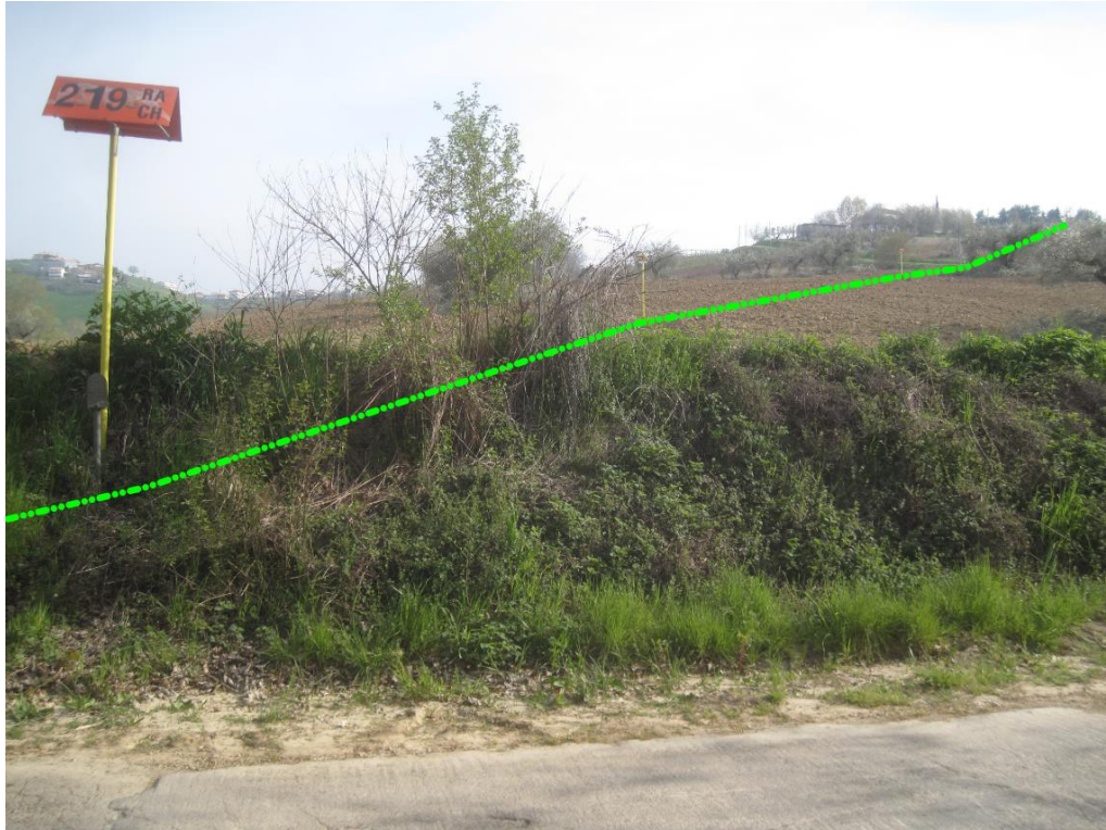
Foto 36 – Area 56. Vista del dissesto dalla strada sottostante
