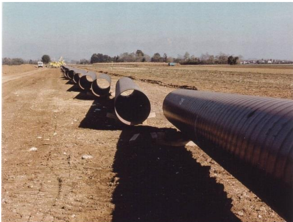
Foto 3.2/D: Esempio di sfilamento tubazioni.
