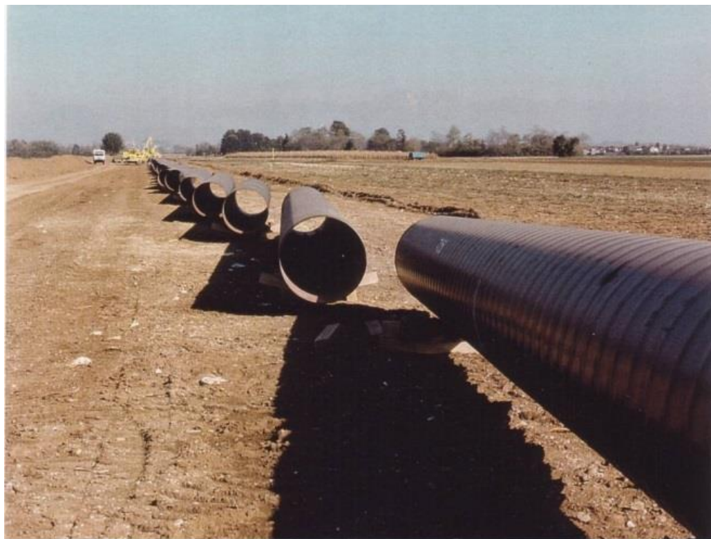
Foto 5.1/D: Esempio di sfilamento tubazioni.
