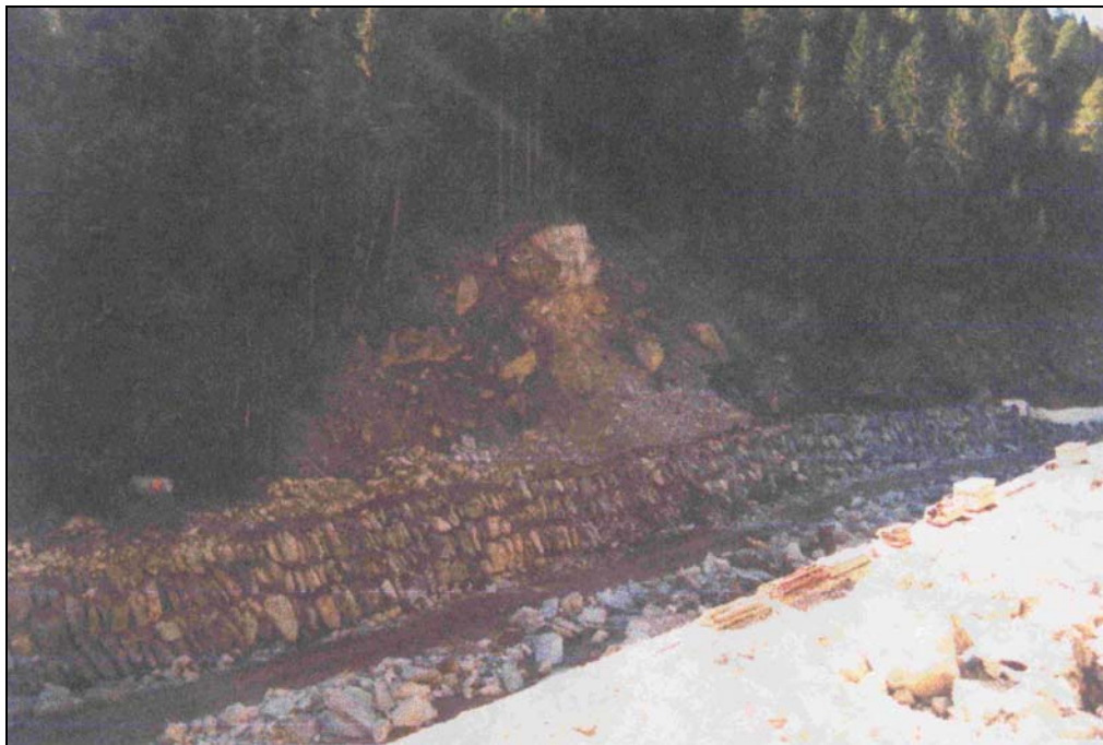
Foto 4-2 - scogliera a coltello ad ultimazione cantiere su scivolo risalita pesci a pendenza 20%.
