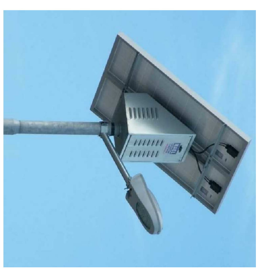
Apparecchio illuminante con ottica standard 48° W, IP66, classe isolamento III con illuminazione forata con area da 2 moduli da 140 W, completa di barre per appoggio e illuminazione della strada interna
