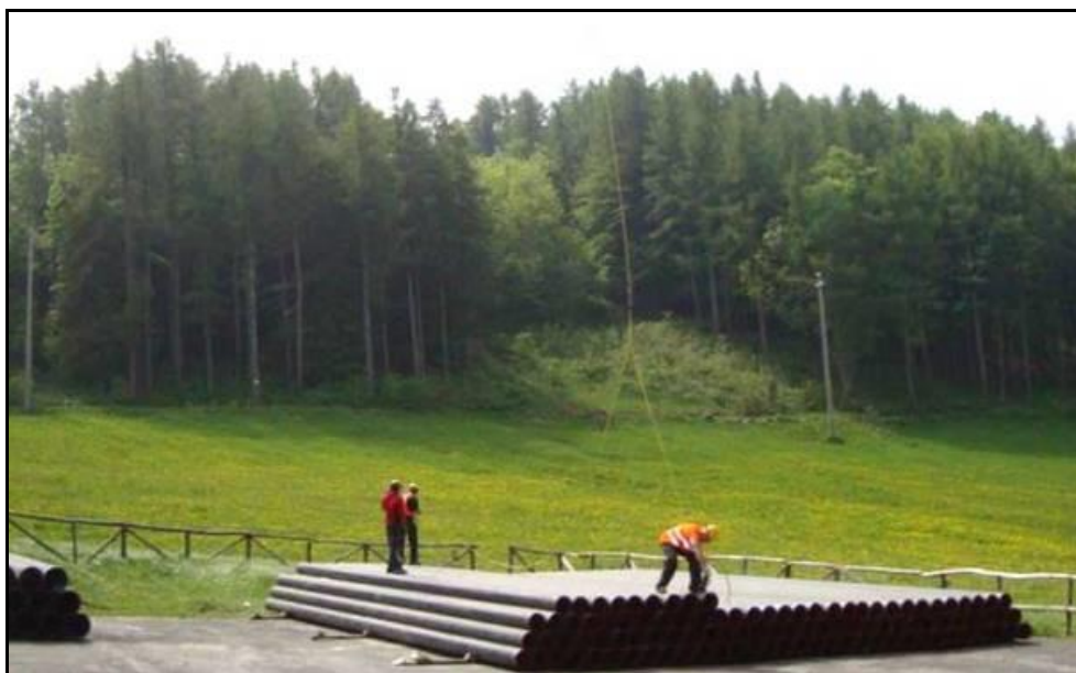
Fig. 5/A: Piazzola di accatastamento tubazioni
