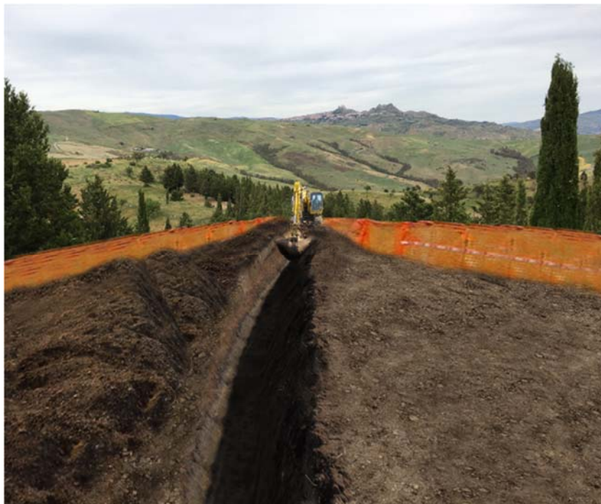
Figura 3/R: Realizzazione della trincea di alloggiamento della condotta in parallelismo al met. in esercizio Gagliano-Capizzi-Sciara DN 500 MOP 75 bar
