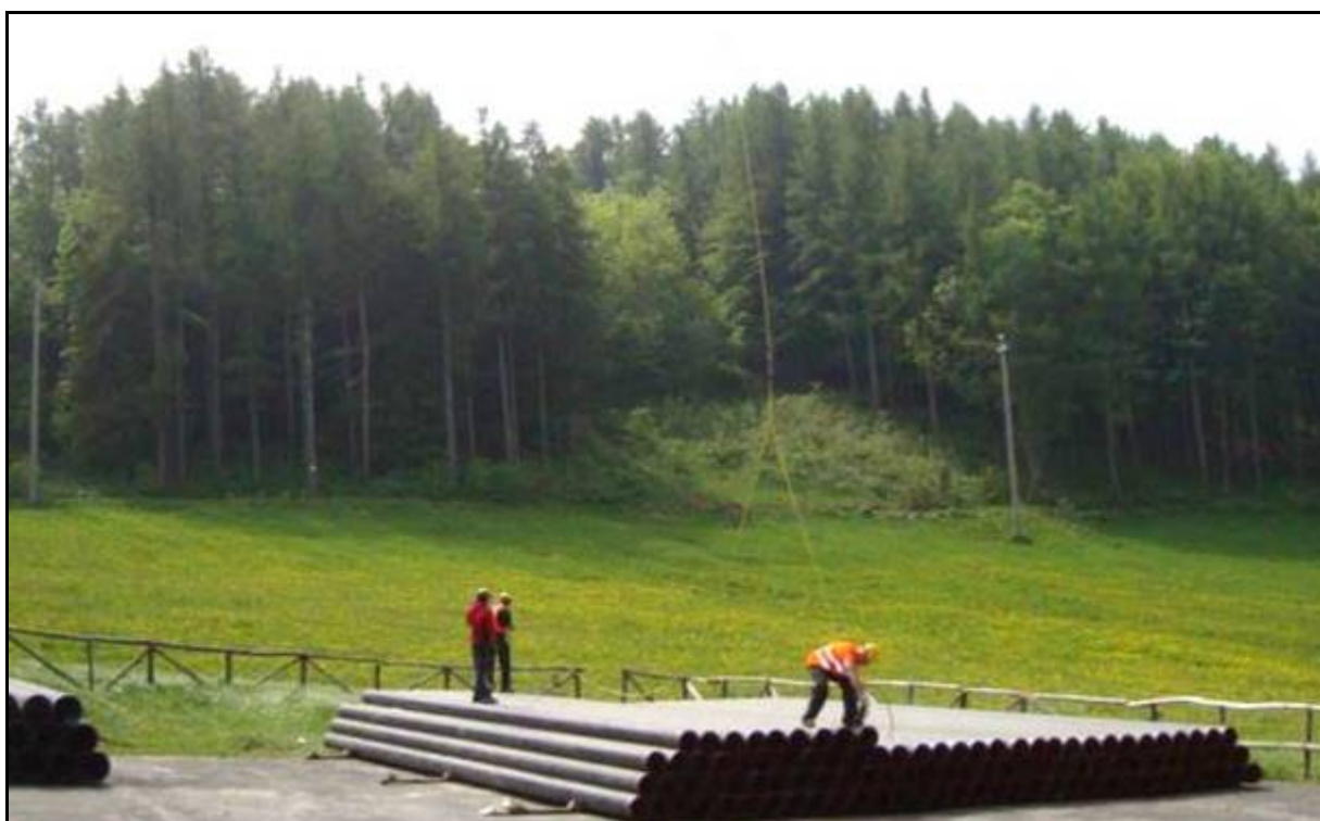
Fig. 5.1/A: Piazzola di accatastamento tubazioni
