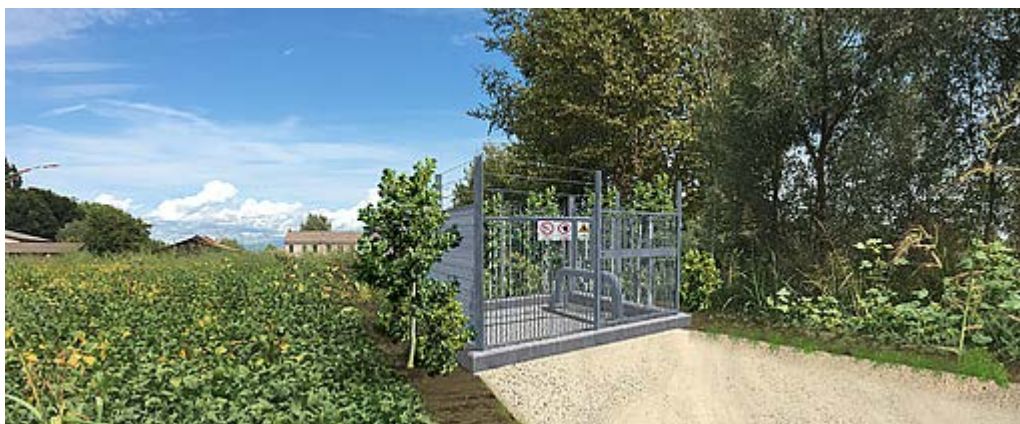
Fig. 4.3/C - Impianto su seminativo in area semi-naturale, fase post-operam
