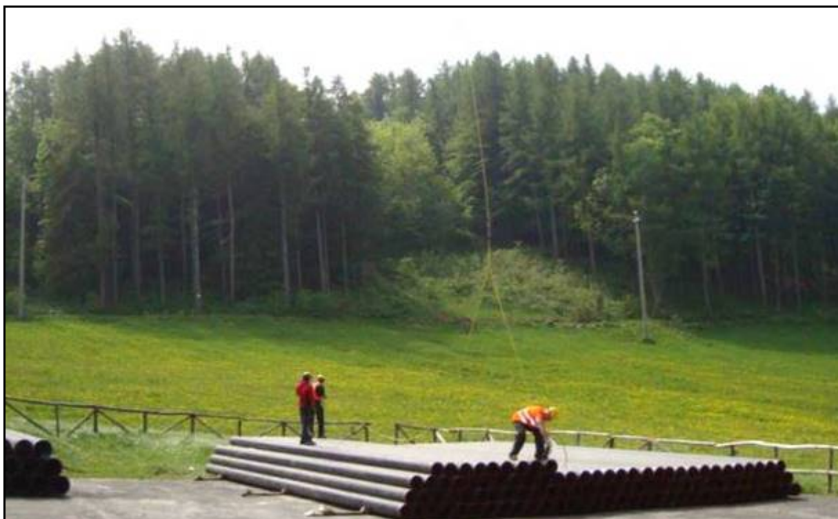
Fig. 9.1/A: Piazzola di accatastamento tubazioni
