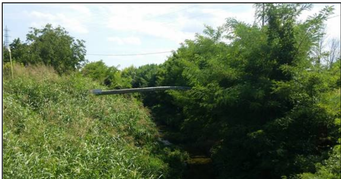
Foto 2.5.2 – Esempio di attraversamento aereo da rimuovere.
