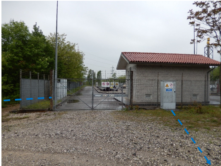
FOTO N.27 - IMPIANTO N.899 ESISTENTE
