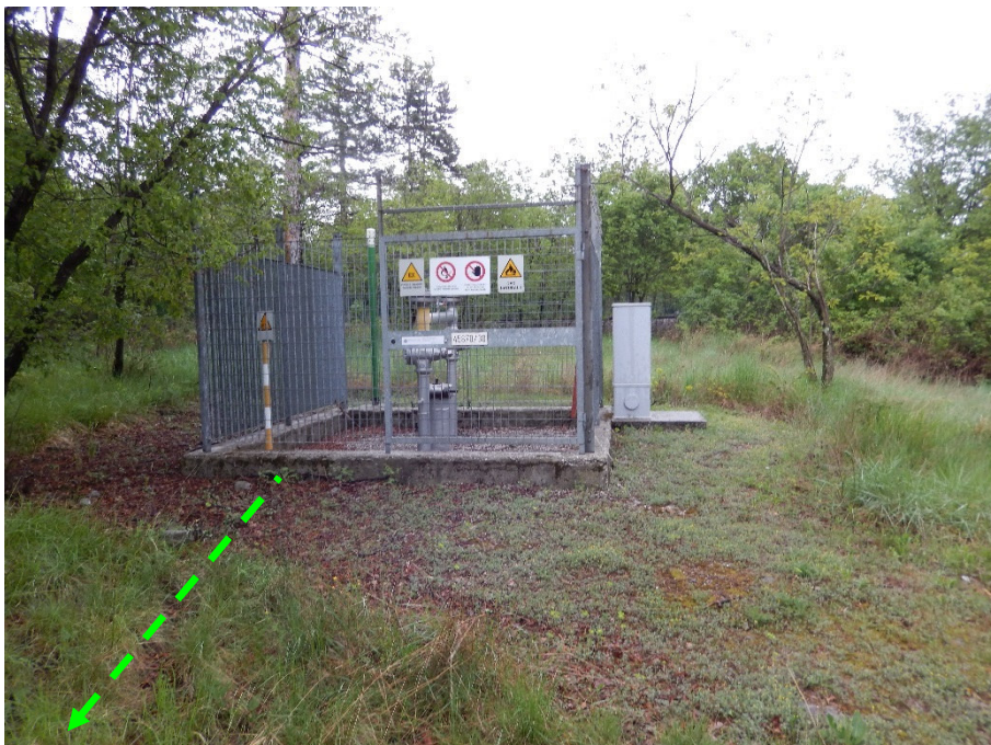
FOTO N.32 - IMPIANTO N. 45870.30 DA DISMETTERE
