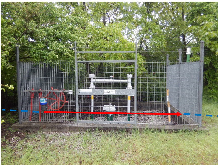
FOTO N.22 - IMPIANTO N. 45870.20 DA DISMETTERE
