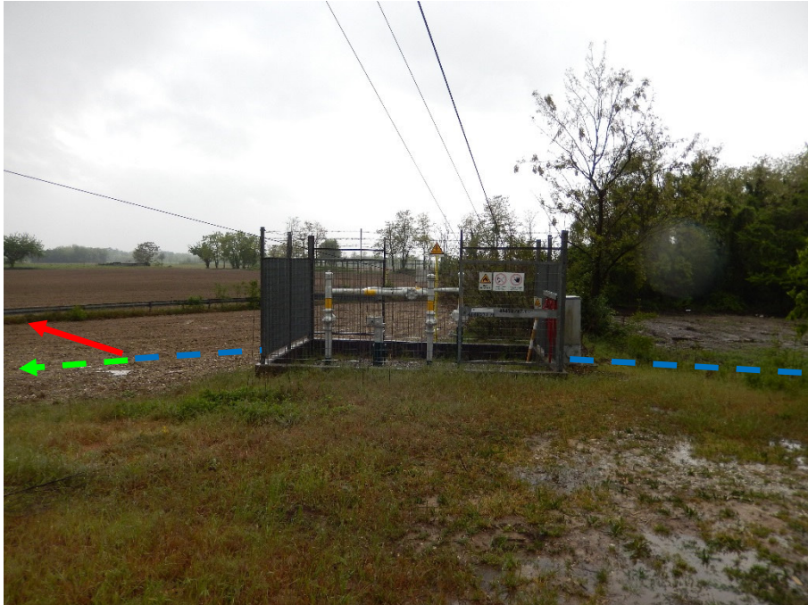
FOTO N.13 - IMPIANTO N.45870.17.1 ESISTENTE
