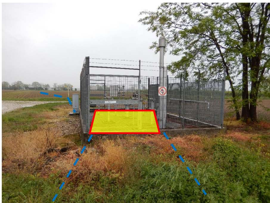
FOTO N.12 - IMPIANTO N. 45870.17 DA DISMETTERE ED INSERIMENTO NUOVO IMPIANTO PID1
