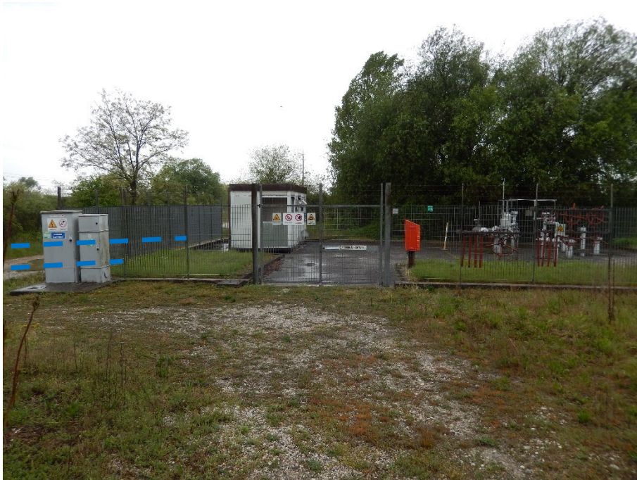
FOTO N.21 - IMPIANTO N.45870.17.2 DA TELECOMANDARE
