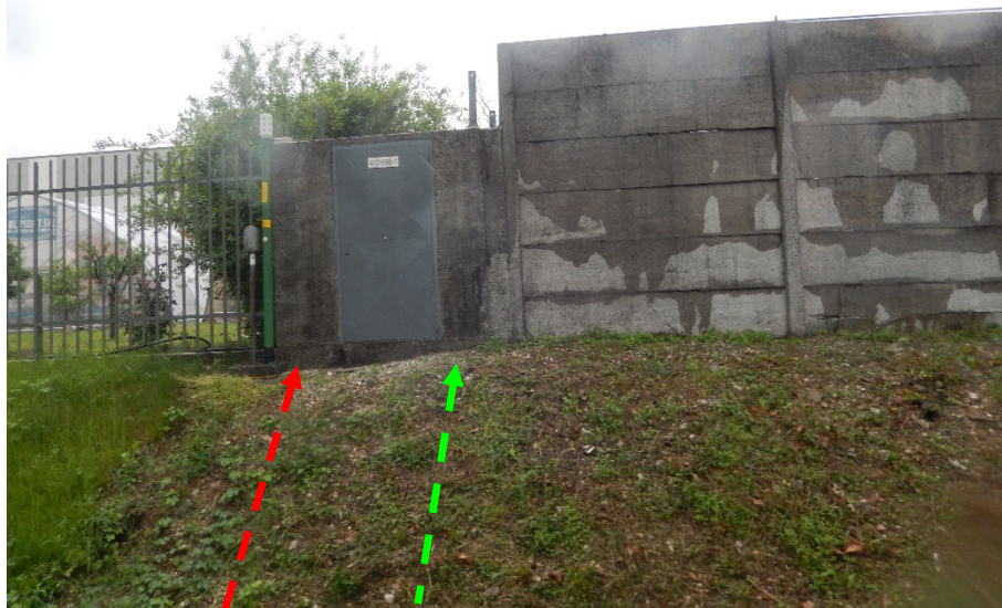
FOTO N.18 - ALLACCIAMENTO IMPIANTO N.4101896.1
