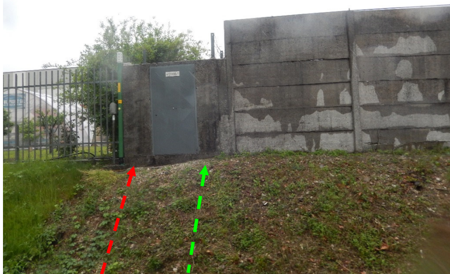
FOTO N.14 - ALLACCIAMENTO IMPIANTO N.4101896.1
