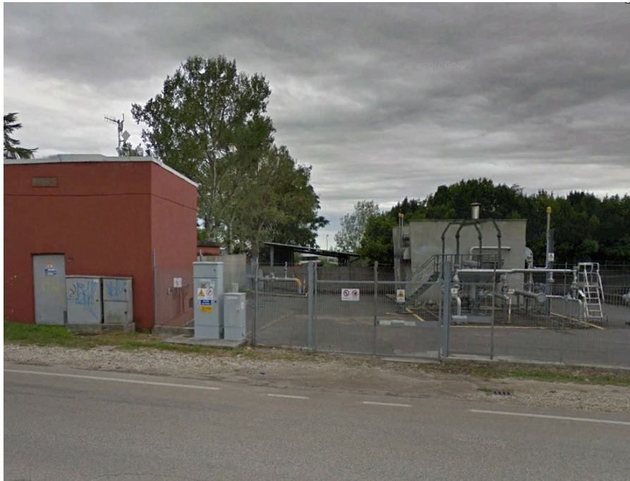
FOTO N.1 - IMPIANTO DI RID. 901 DA DISMETTERE
