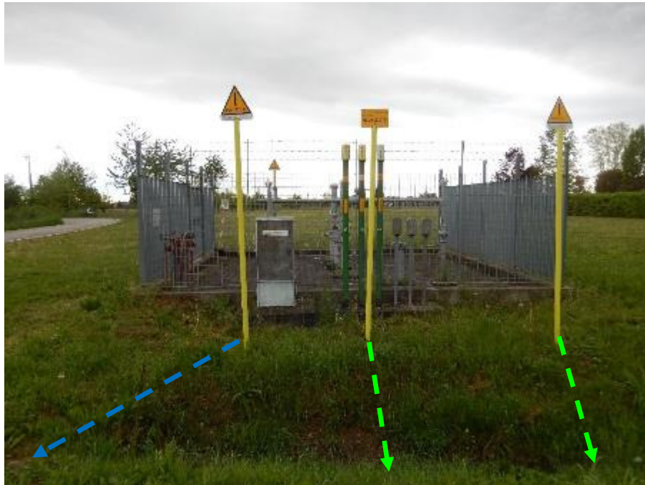
FOTO N.1 - IMPIANTO N.4105644.2 ESISTENTE
