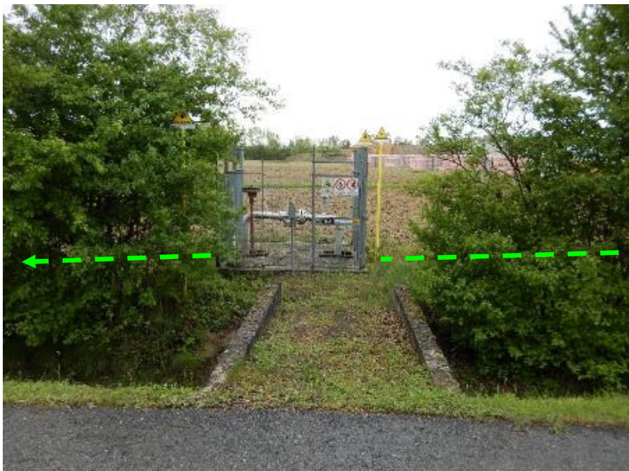
FOTO N.10 - IMPIANTO N.4102130.1 DA DISMETTERE
