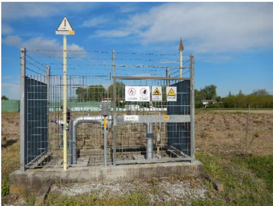
FOTO N.122 - IMPIANTO N. 4104762.1 DA DISMETTERE
