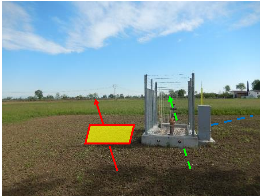
FOTO N.71- IMPIANTO N.4101211.1 DA DISMETTERE
