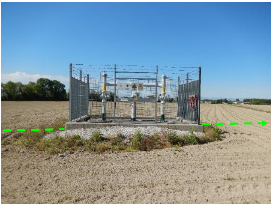
FOTO N.104 - IMPIANTO N.45870.8 DA DISMETTERE
