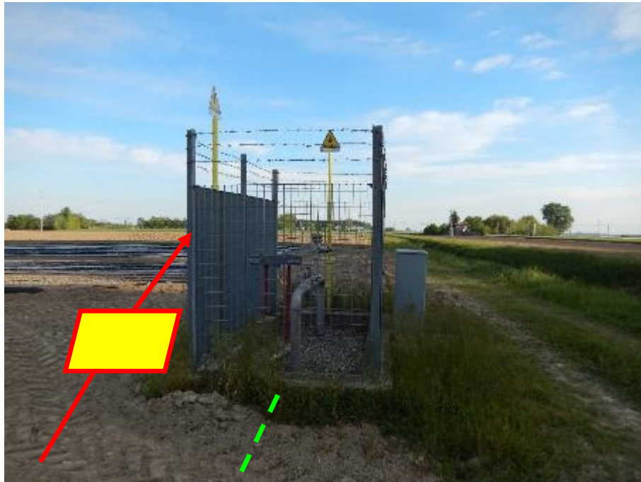
FOTO N.131 - IMPIANTO N.4102379.1 DA DISMETTERE E NUOVO IMPIANTO IN PROGETTO
