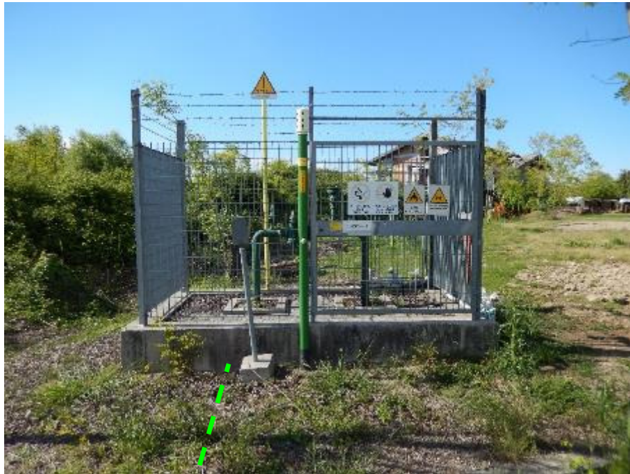
FOTO N.107 - IMPIANTO N.4140088.1 DA DISMETTERE
