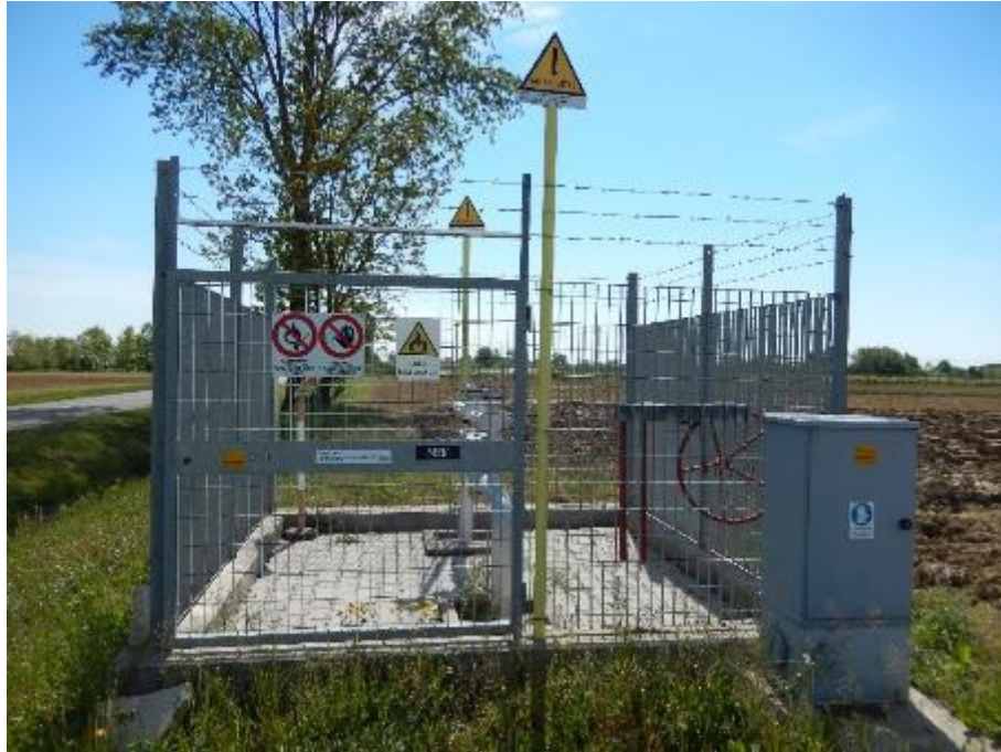
FOTO N.87 - IMPIANTO N.13498.1 DA DISMETTERE
