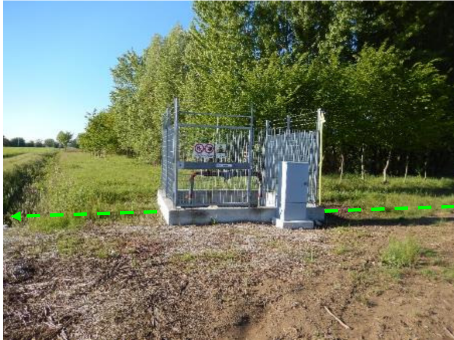
FOTO N.15 - IMPIANTO N.41009720.1 DA DISMETTERE
