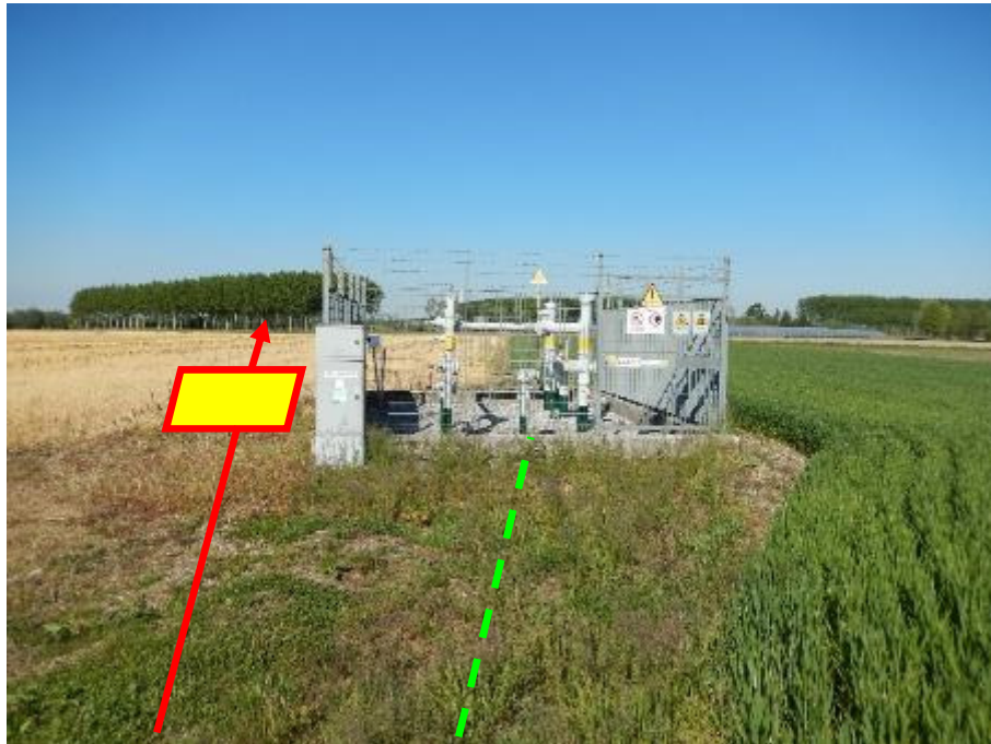
FOTO N.139 - IMPIANTO N.45870.10.1 DA DISMETTERE
