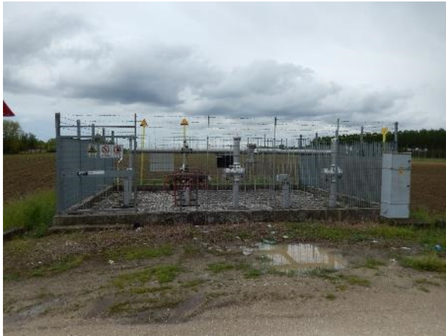
FOTO N.1 - IMPIANTO N. 458702 DA DISMETTERE
