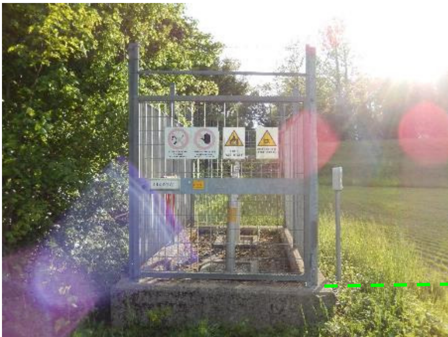
FOTO N.128 - IMPIANTO N.4140297.1 DA DISMETTERE
