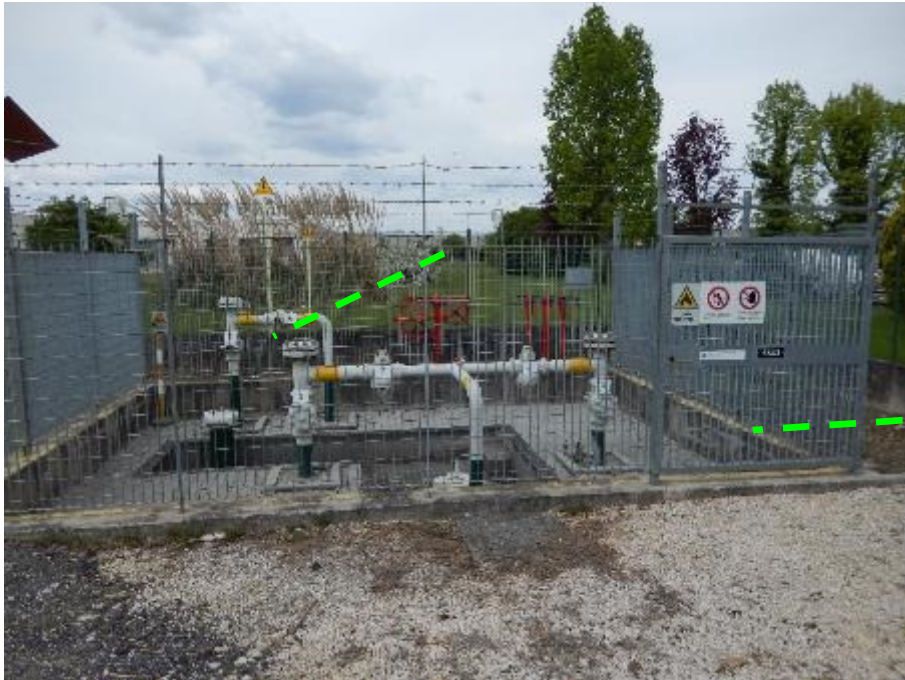
FOTO N.1 - IMPIANTO N.45870.3 DA DISMETTERE
