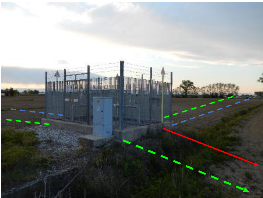
FOTO N.22 - IMPIANTO N. 77156.3.1 DA DISMETTERE
