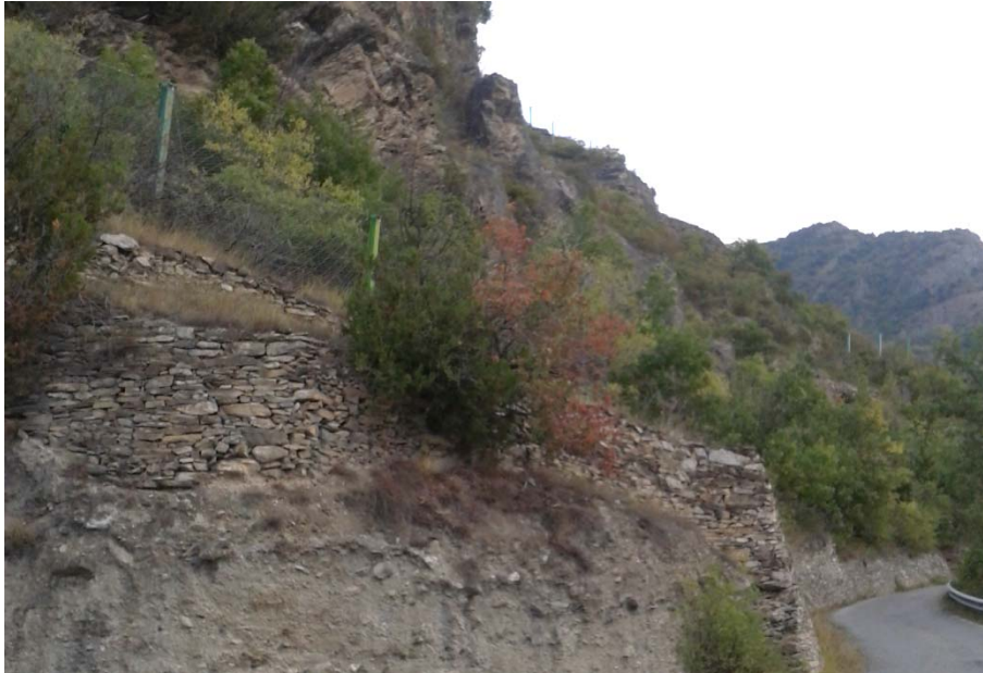
Figura 19 – Strada per Seghino sopra urbiano, a quota 630 m circa. A monte della strada sono visibili le barriere paramassi installate circa 30 anni fa.
