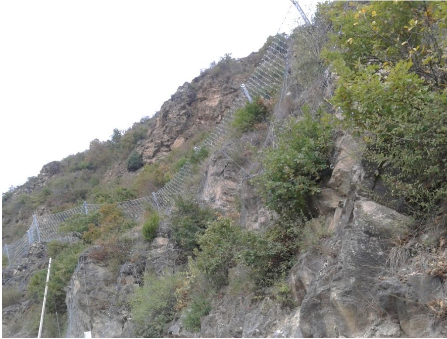
Figura 21 – Barriere paramassi installate nel 2012 lungo la strada per Seghino (quota 660 m circa).
