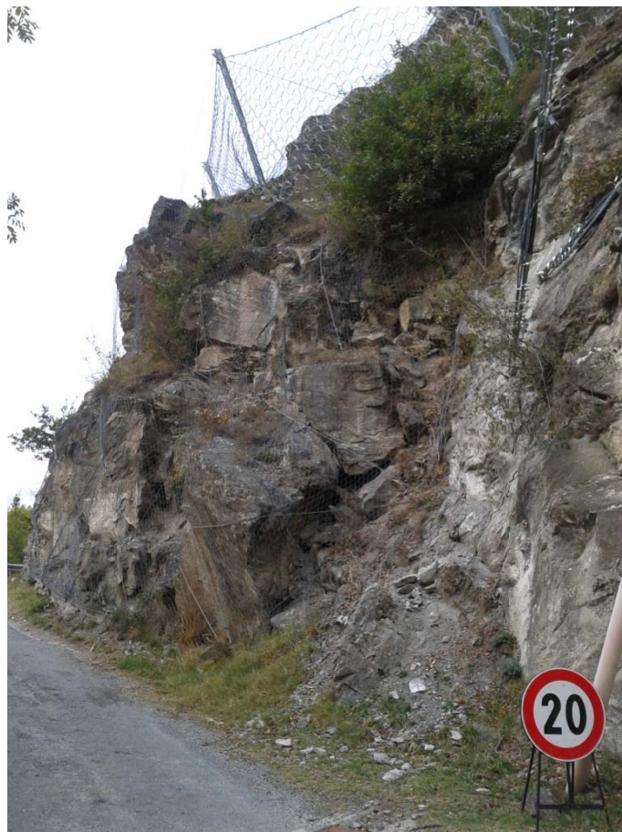
Figura 24 – Massi instabili fratturati sopra la strada per Seghino (quota 660 m circa).
