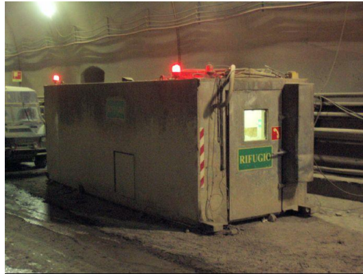
Container di salvataggio interno alla galleria (arca)
