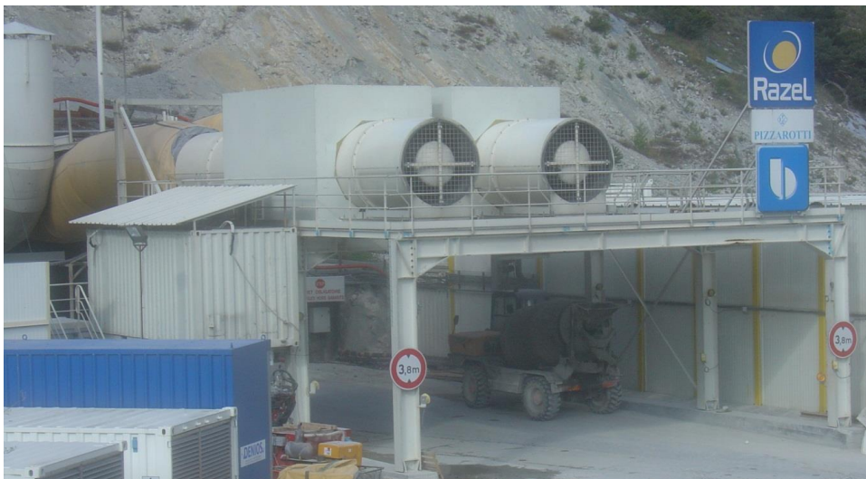
Particolare dei silenziatori e carter di insonorizzazione dei motori
