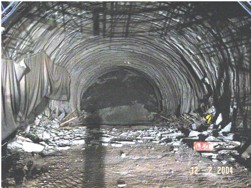
Figura 11: Immagine del fornello avvenuto nella galleria esistente al momento della costruzione.
