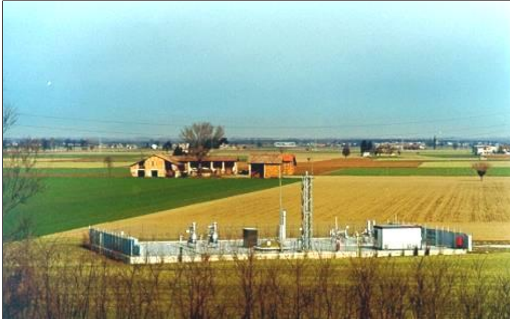
Fig. 5.1/P: Installazione tipo impianto di regolazione/riduzione
