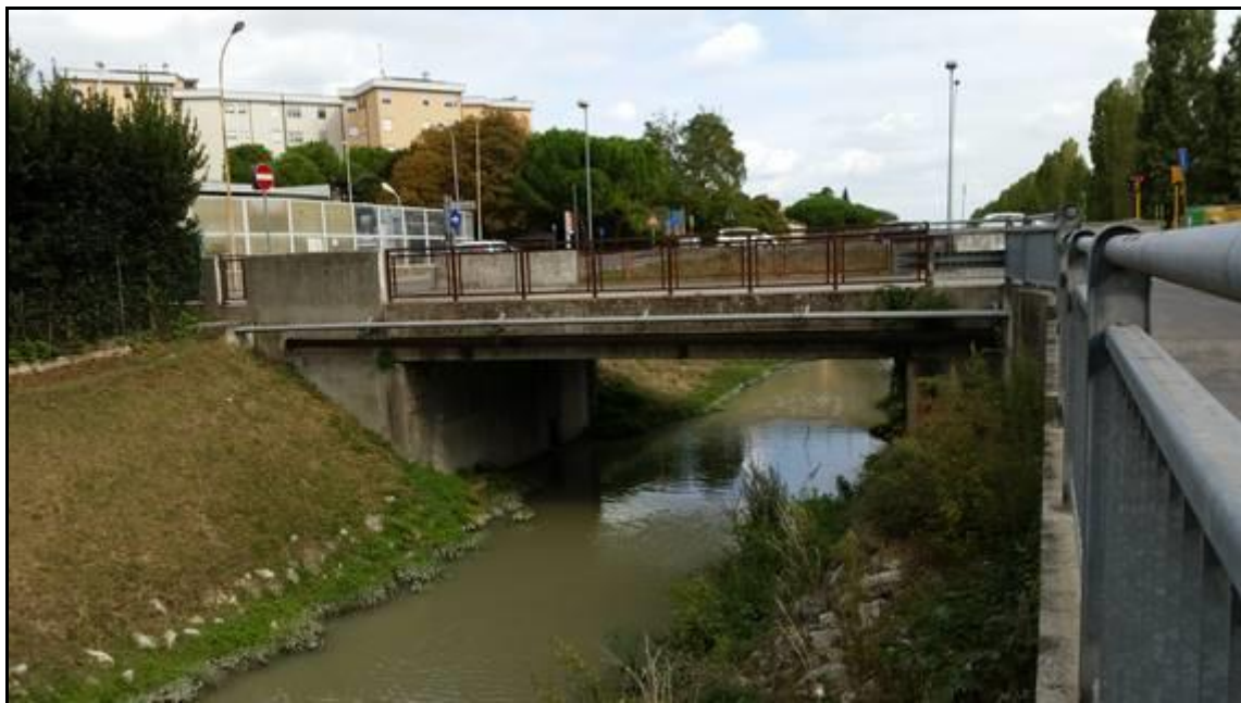
Foto n. 2.2.1/E – Canale principale in area urbana (Can. Lama) - attraversamento di metanodotto immerso al ponte -
