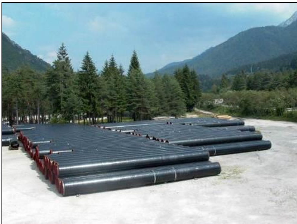
Fig. 2.5/A: Piazzola di accatastamento tubazioni
