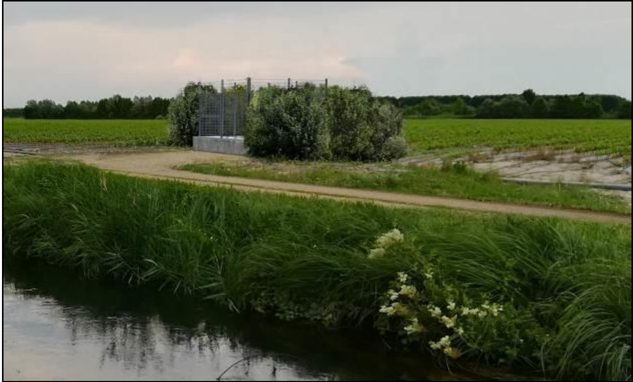
Fig. 2.5/S: Impianto tipo PIL con mascheramento arbustivo
