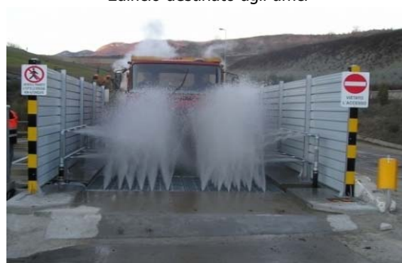
Impianto di lavaggio ruote per i mezzi pesanti
