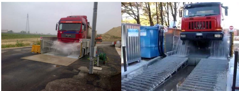
Figura 9-1 Esempio di impianto di lavaggio ruote
